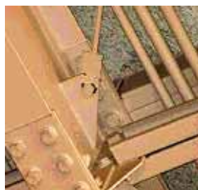
写真3 Nd45 ボルトのすべり
