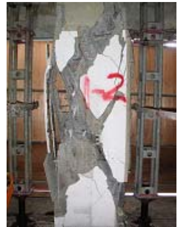
(a)柱東面 写真2 柱9B
