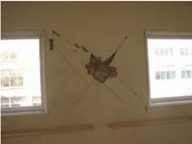
写真 - 2 2階柱の損傷度 の被害状況
