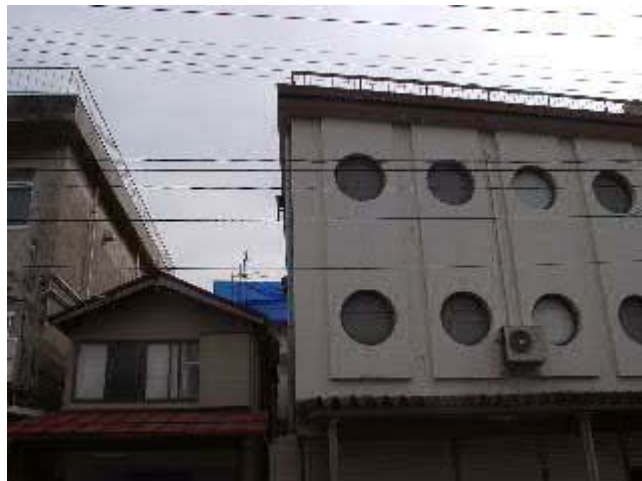
写真 3 後ろのブルーシートが塔屋部分
