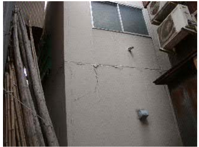
写真7 残っている部分もひび割れている
