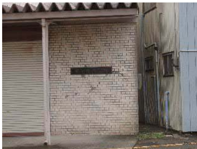
写真 2 表のタイルのせん断ひび割れ
