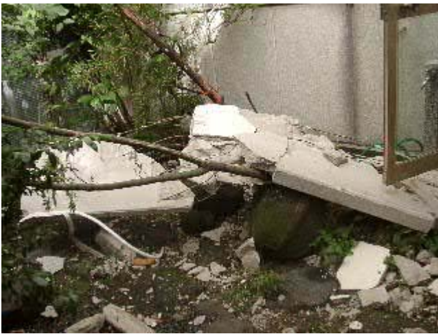
写真5 落下して破損したALC版(縦壁)
