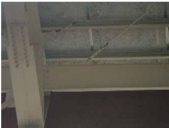
写真 - 1 1 屋根面ブレースのターンバックル部での破断
