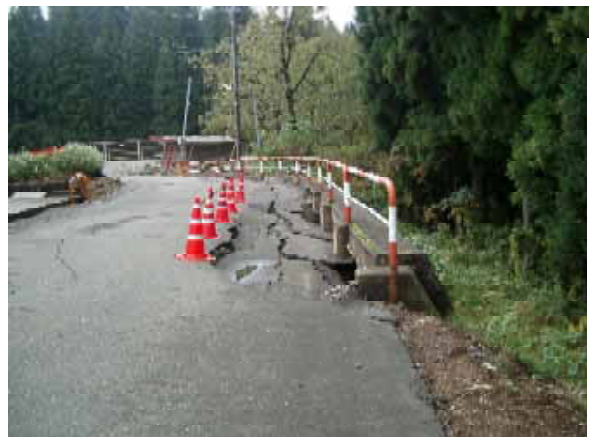
図-3 敷地の状況 (盛り土部分が沈下している。)
