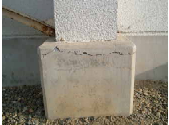
写真 - 1 3 柱脚コンクリートのひび割れ
