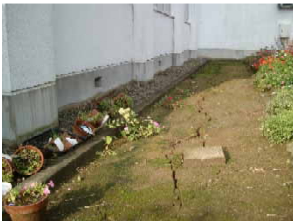
写真 - 5 校舎棟周囲の地盤沈下
