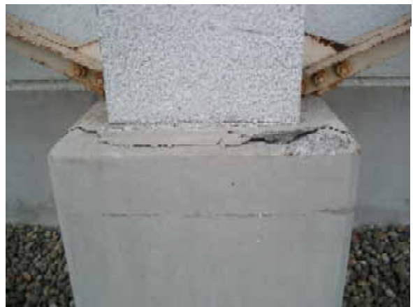
写真 - 1 4 柱脚コンクリートのひび割れ
