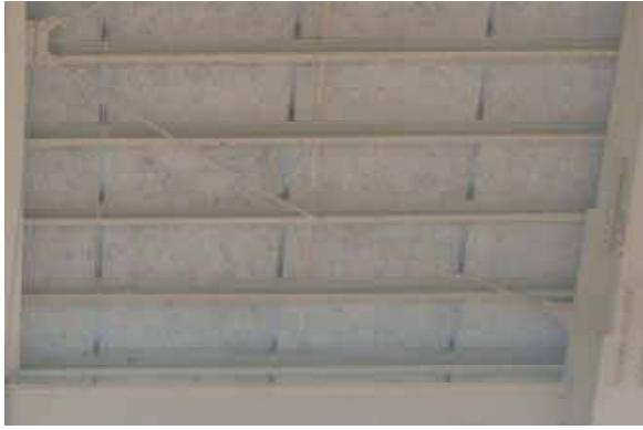
写真 - 1 0 屋根面ブレースの残留変形
