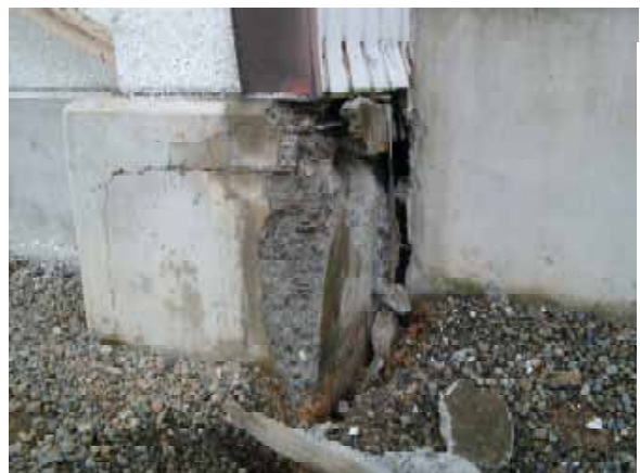
写真 - 9 体育館本体と附属部分との取り合い部
