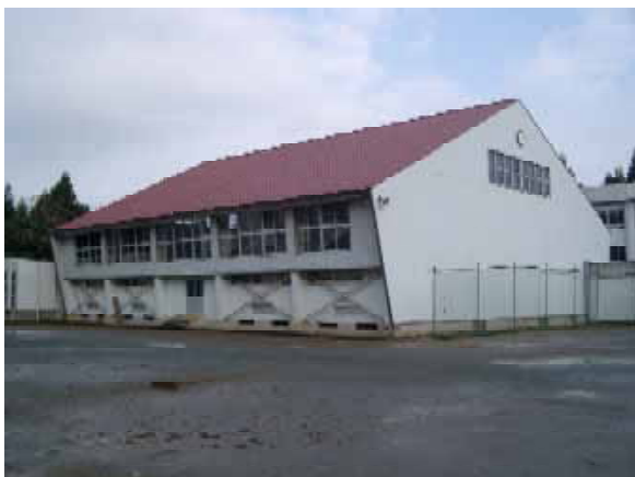
図 - 6 体育館全景（柱脚，壁面ブレース，屋根根面ブレース等に多数の被害が見られる。）
