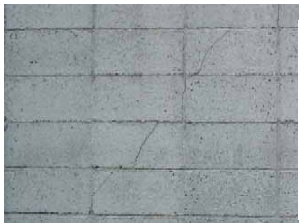
写真 - 8 ブロック壁のせん断ひび割れ
