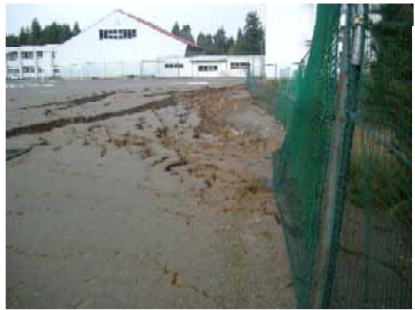
図-2 敷地の状況 (グランド東側が大きく崩落しており, その西側にも地割れが生じている。)
