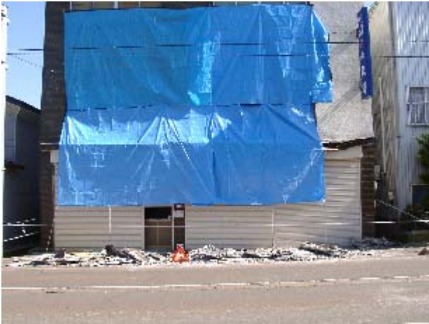
写真-4.3 商店Aの外壁剥落(このあたりから南側の地域は停電)
