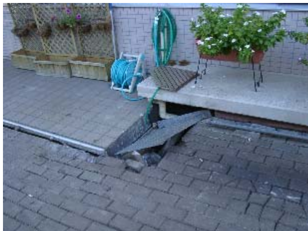
写真-5.19 免震建物の外構の損傷
