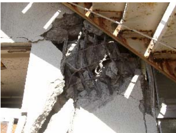
写真-5.16 1 階柱のせん断破壊後の圧縮破壊 : 幅仕上げ含み 600mm、主筋 2φ、帯筋 9 @ 約 150 ( 90 度フック )
