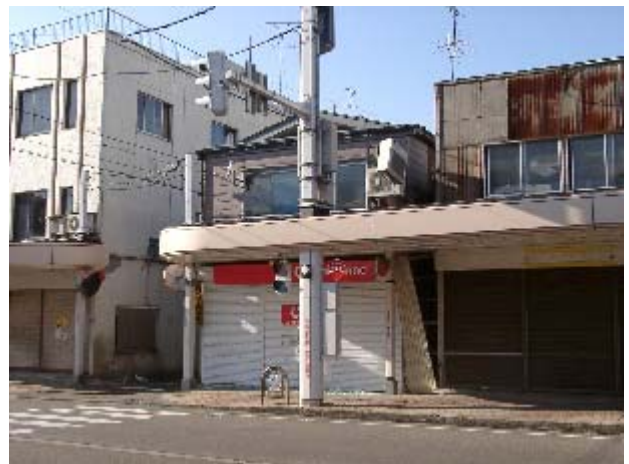
写真-5.26 2階外壁に取付けた室外機の倒れ
