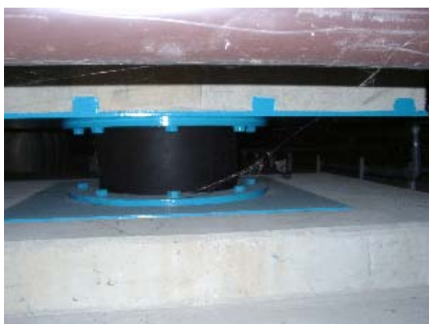
写真-5.20 積層ゴムの残留変形：暗くてよくわからないが変形が認められる。
