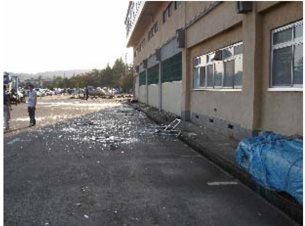
写真-5.12 市民体育館のガラスの割れ
