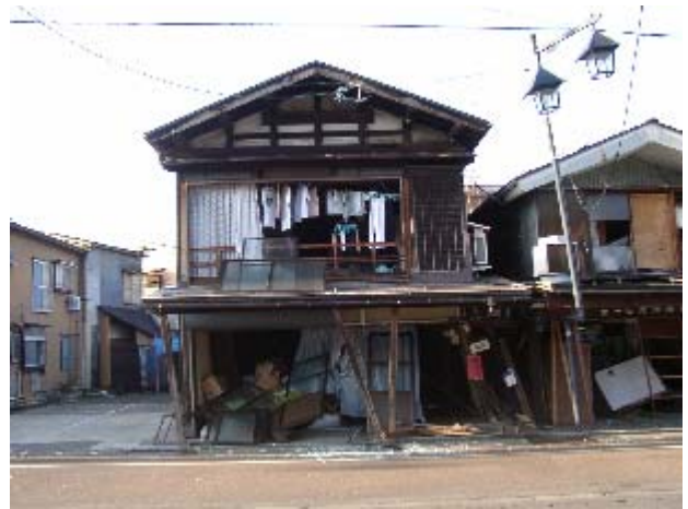
写真-5.32 被災後立入り禁止となる木造住宅：建物の傾斜が立入り禁止の理由
