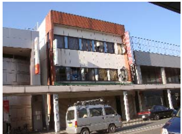
写真-5.27 店舗の外壁損傷状況：2, 3F がプレキャストのコンクリートのようにあるが一部コンクリートが剥落
