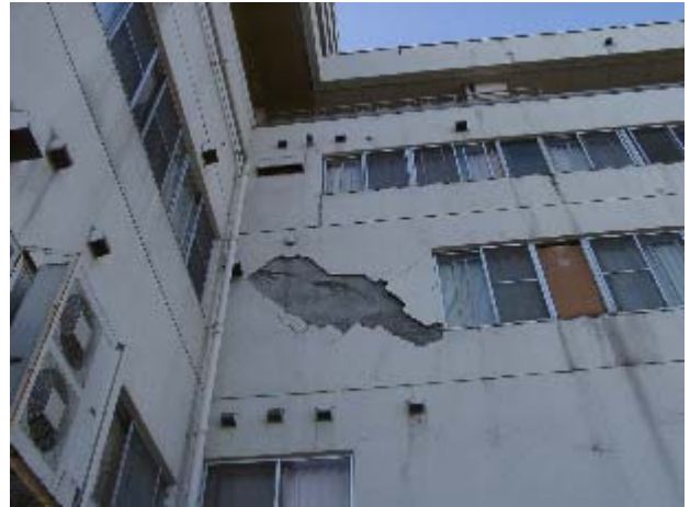
写真-5.17 南側 3F 袖壁に生じたせん断破壊
