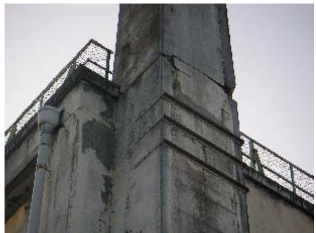
写真-5.4 小千谷小学校の煙突のひび割れ：曲げひび割れが全面に広がっていて危険な状態にある。
