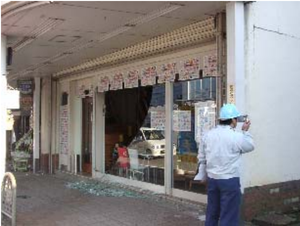
写真-5.28 店舗のガラスの割れ
