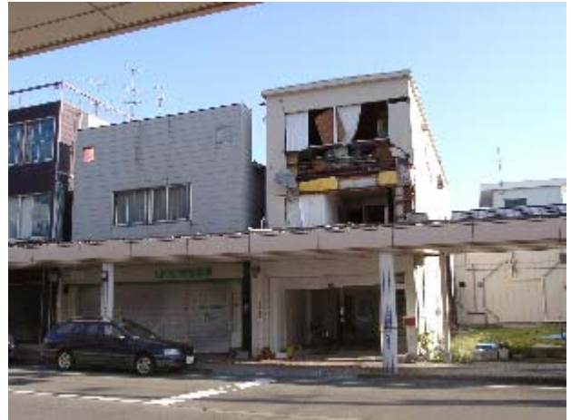
写真-5.25 鉄骨造の店舗兼住宅の外壁剥落状況
