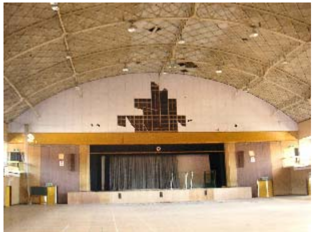
写真-5.13 体育館内の様子：RS系のSK式シャーレーン？、剛床ありそうだが、ガラスが割れ、内装も剥落あり、避難所として使われていなかった。
