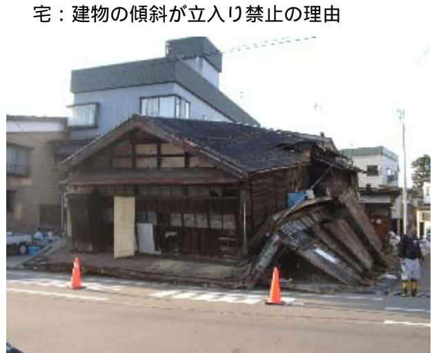
写真-5.33 1階が倒壊した木造住宅
