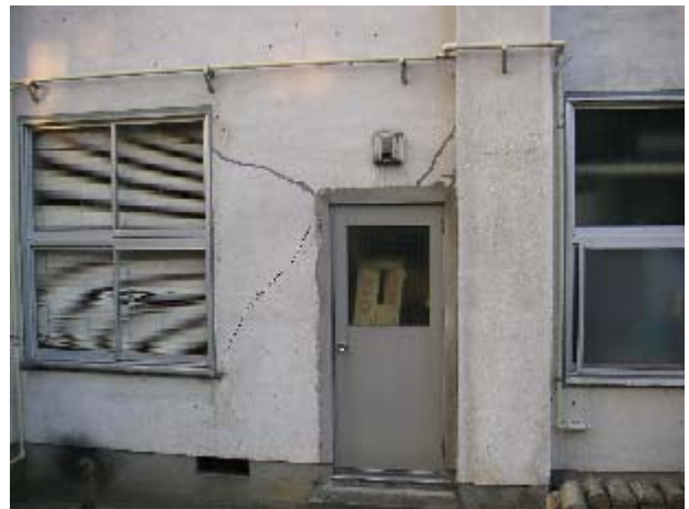
写真-5.3 小千谷小学校の外壁のせん断破壊
