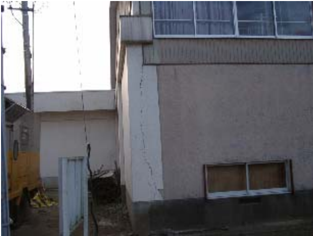
写真-5.10 千田中学校体育館の柱に入ったひび割れ
