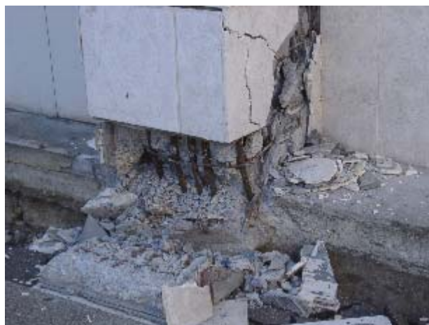
写真-5.22 柱脚の破壊状況：東西方向の柱脚ヒンジ領域の(曲げ破壊後の?)せん断破壊、主筋の座屈が見られる。52×58cm角(仕上げ無し)、主筋22、帯筋9@約150(90度フック)
