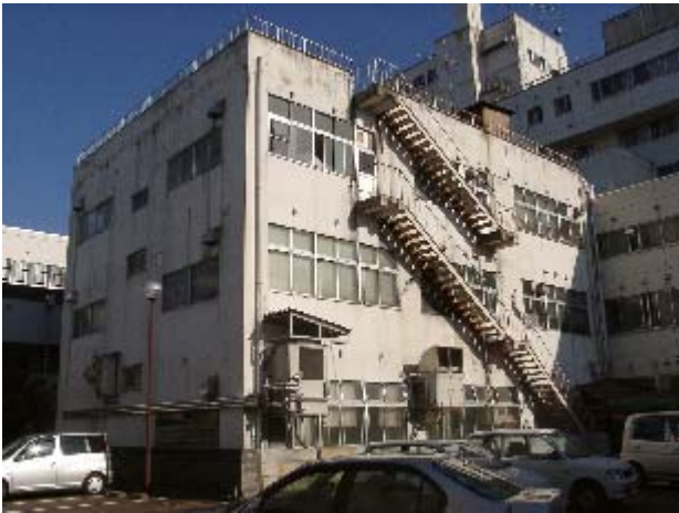
写真-5.15 小千谷総合病院の北西側張り出し部分 : 1F の柱がせん断破壊し、軸耐力を失っている。ここは資料室らしく、全体の建物の 3F 以下は通常に機能していた。柱の詳細は次の写真。
