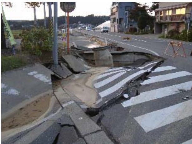
写真-5.6 千田小学校前の陥没した道路
