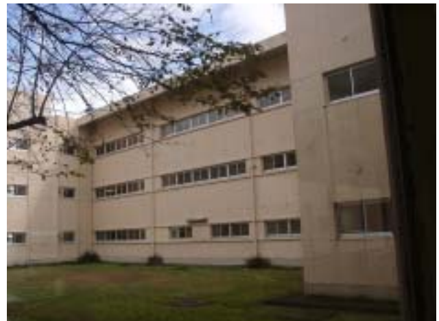
写真-53 十日町総合高校管理棟の中庭に面した中央部分を北からみた外観。建物の北側は、ウォールガーダーにとりつく扁平な柱であるが、中央2階に被害の最も大きい柱がみえる。詳細は次の
