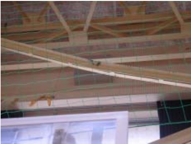
写真-29 南中学校体育館の4つの桁行きブレースの内1つに座屈がみられた。
