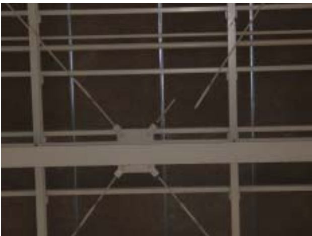
写真-11 川治小学校の体育館の屋根ブレースに破断がみられた。
