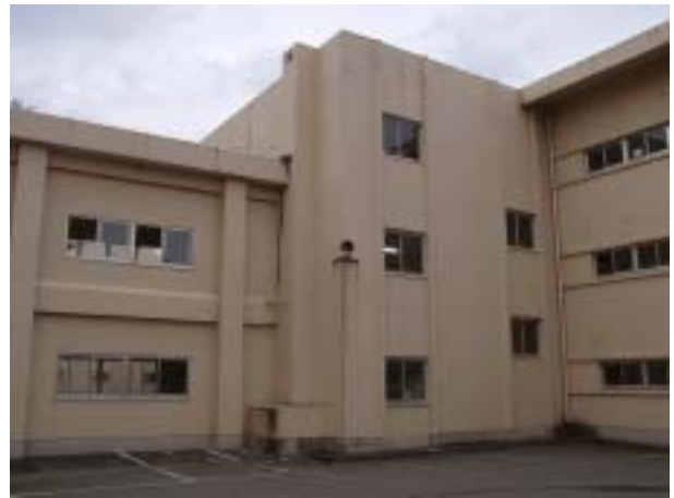
写真-57 管理棟の階段室との取り付け部の破壊。
