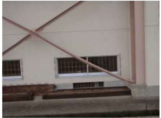
写真-17 鑑島小学校の体育館の桁行きブレースが座屈により湾曲していた。
