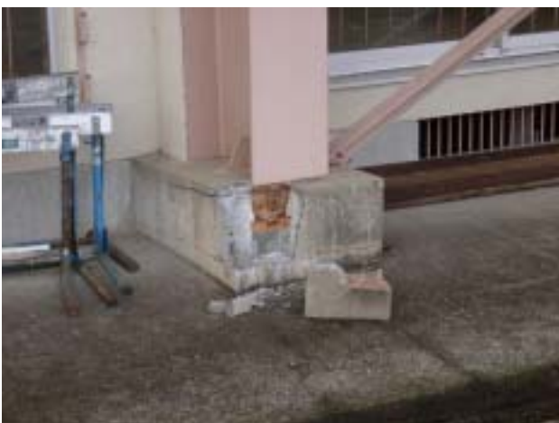
写真-16 鑑島小学校の体育館の桁行きブレースの脚部に損傷がみられた。
