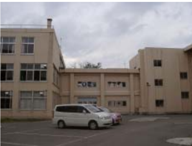
写真-56 十日町総合高校管理棟と特別教室棟を繋ぐ渡り廊下棟（RC2F）。両側の接続する部分にコンクリートの剥落がみえる。詳細は以下の2枚の写真。
