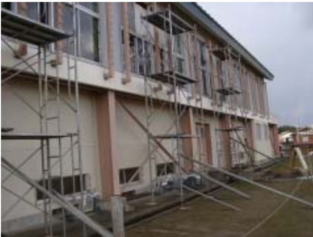
写真-15 鑑島小学校の体育館の桁行き方向、桁行きブレースは、その脚部に損傷がみられたほか、ブレース自体が座屈により湾曲してるのもあった（以下の写真参照）。
