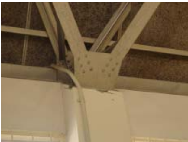
写真-6 十日町小学校の体育館（1971 年竣工）の屋根ブレースの脚部に損傷が見られた。
