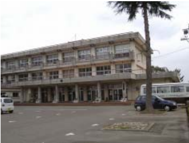
写真-19 南中学校管理普通教室棟(南側の棟、RC3F)の外観。被害は軽微。
