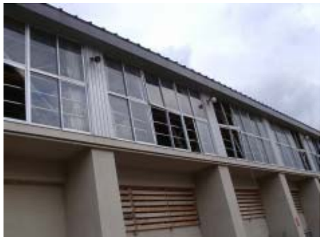
写真-33 十日町中学校体育館の割れたガラス。
