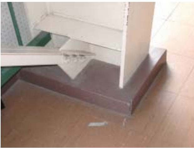
写真-10 川治小学校の体育館の桁行きブレースの脚部に損傷が見られた。
