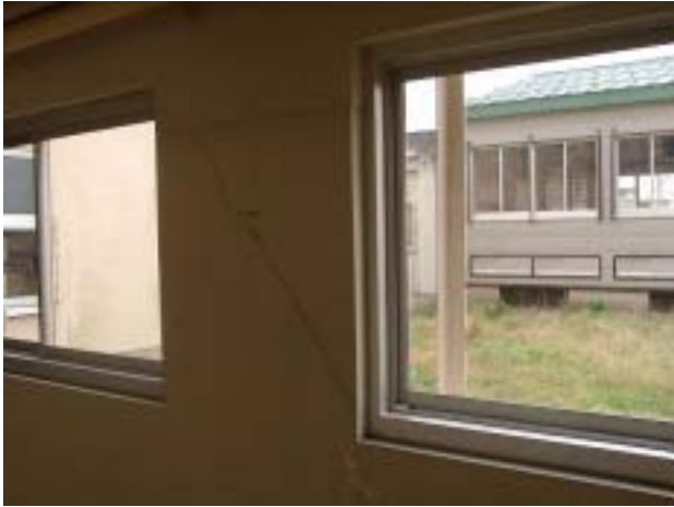
写真-60 十日町総合高校特別教室棟の北側の柱にせん断ひび割れがみられた。
