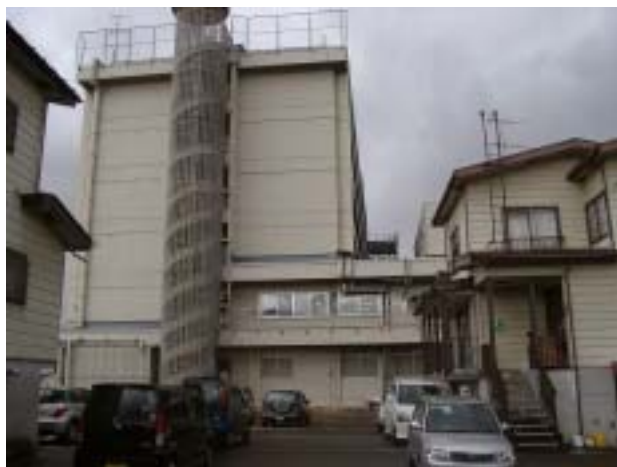
写真-74 十日町病院の病棟の東面。2 階部分の柱にせん断ひび割れが多くみられた。詳細は次の写真。
