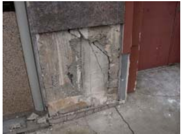
写真-68 中央に位置する柱の損傷。せん断破壊により軸変形が認められる。
