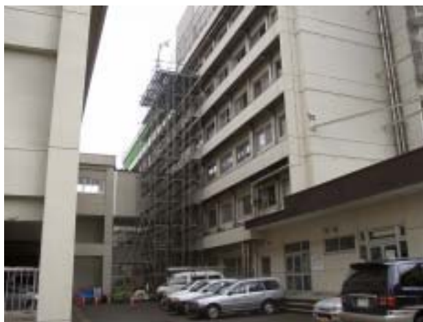
写真-73 十日町病院の病棟の北西面。右側に見える 2 階の連層耐震壁の柱にせん断破壊による圧壊がみられた。
