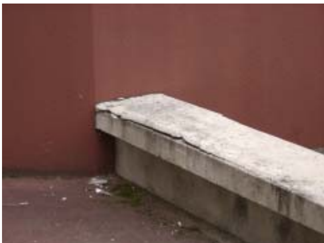
写真-45 エントランスの車寄せでわずかなコンクリートの損傷がみられた。
