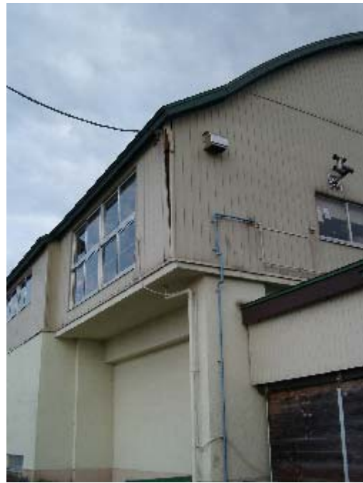
写真-42 西体育館の外壁に浮き上がりが観察された。
