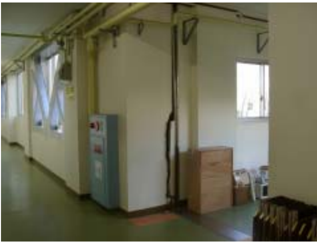
写真-40 渡り廊下棟と第2棟棟の EXP.J.に損傷が見られた。
