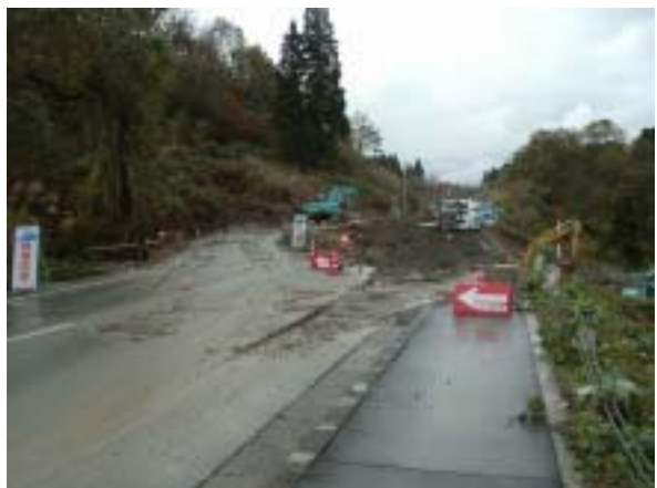
写真-82 道路の片側がえぐり取られている。
