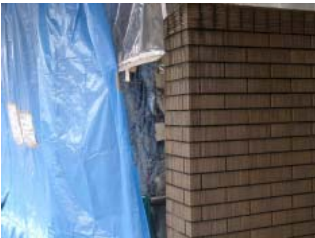
写真-67 117号に面した柱の損傷。
