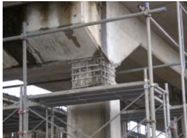
写真-79 ラーメンの柱頭のせん断破壊。下からの軸方向鉄筋の180度フックがみえる。段落とし部でのせん断破壊と思われる。
