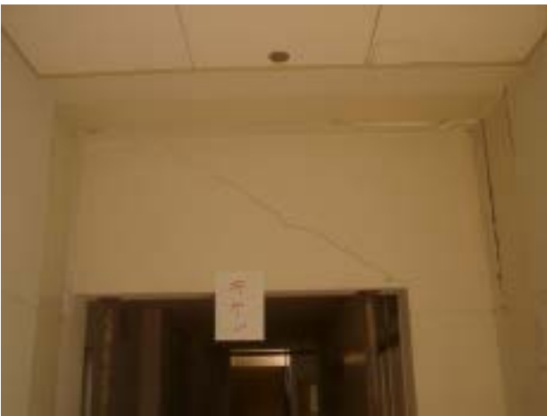
写真-55 管理棟の階段室の桁行き方向の梁にせん断ひび割れがみられた。
