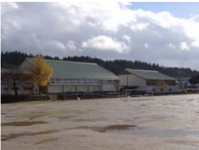
写真-41 西体育館（左）と屋内練習場（右）の外観。外壁に軽微な被害が見られた。（詳細は次の写真）。いずれも屋根プレースが座屈し、立ち入り禁止とのこと。
