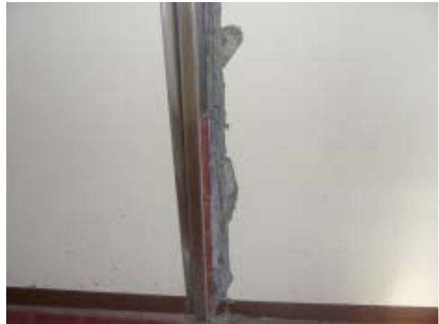
写真-8 特別教室棟と給食室棟との間の EXP.J.のモルタルが大きく剥落した損傷が見られた。
