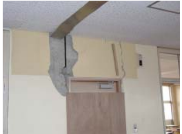
写真-21 南中学校管理普通教室棟2棟の間のEXP.Jの損傷。
