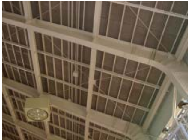
写真-12 川治小学校の体育館の屋根ブレースはほとんどが座屈してたわんでいる。
