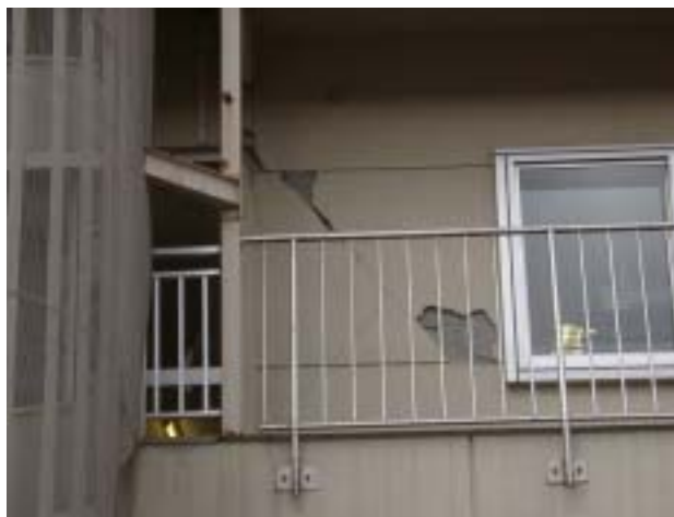
写真-75 十日町病院の病棟の 2 階の東面の方立て壁のせん断ひび割れ。
