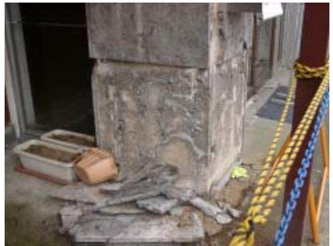
写真-69 117号から最も離れている柱の損傷。仕上げはとれているが、躯体の損傷は激しくない。
