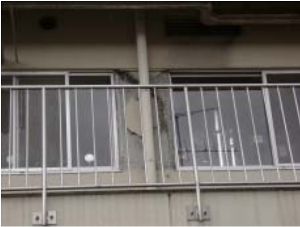
写真-76 十日町病院の病棟の2階の東面の柱のせん断ひび割れ。
