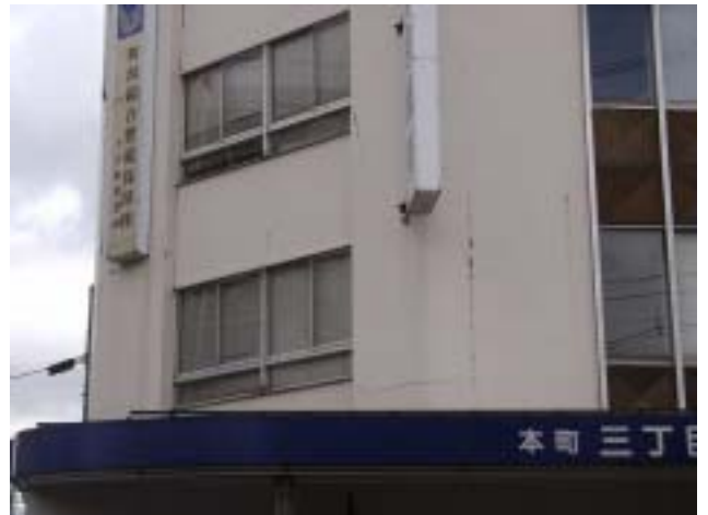
写真-70 十日町商工会議所の2階には曲げとせん断のひび割れが観察される程度であった。
