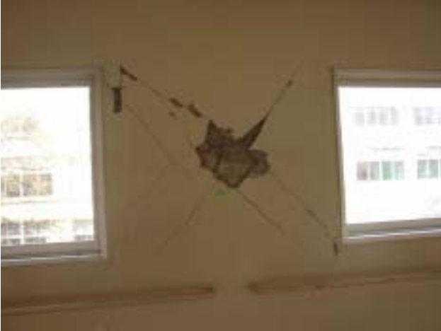
写真-54 十日町総合高校管理棟の北側2階のウォールガーダーにとりつく扁平な柱せん断破壊（被災度）。
