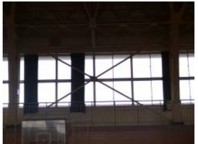
写真-28 南中学校体育館の4つの桁行きブレースの内1つに座屈がみられた。右下のブレースが湾曲している。
