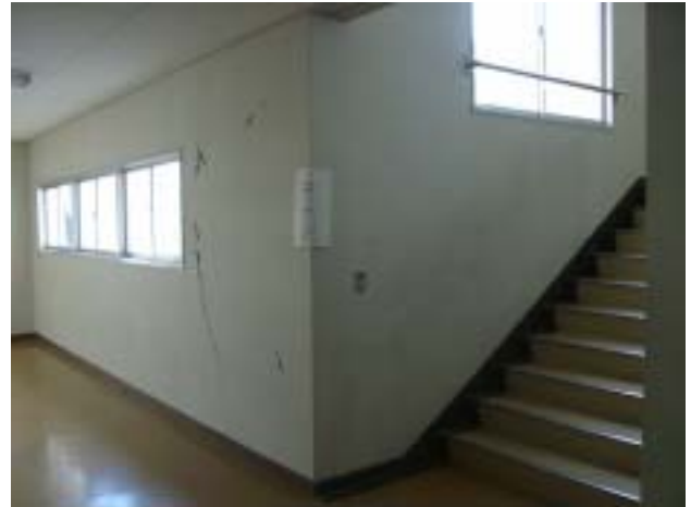
写真-52 階段室とのつなぎ目の柱の被害。
