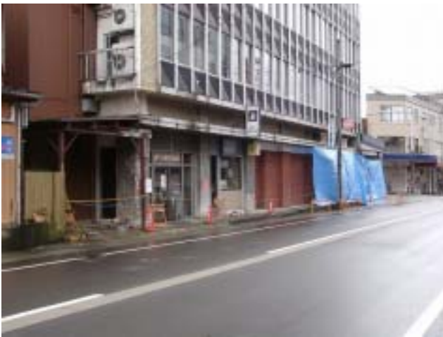
写真-66 柱の損傷が向こう(117号)にいくほど激しくなる。
