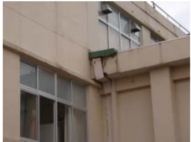
写真-58 特別教室棟とのエキスパンションジョイントの被害。
