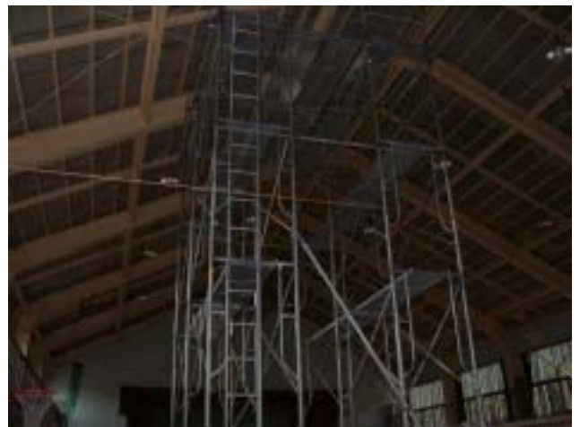
写真-18 鑑島小学校の屋内体育館は、ほとんどの屋根ブレースが座屈あるいは破断し、既に取り替え作業が始まっていた。
