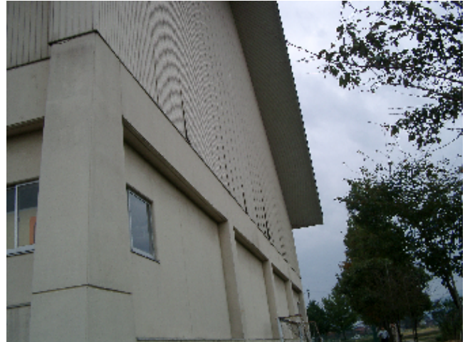
写真-26 南中学校体育館の妻部の外壁の浮き上がり。
