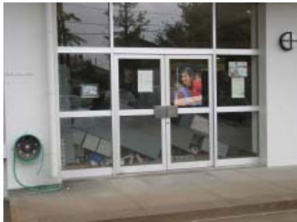
写真-36 十日町高校第 2 棟のエンタランスでは、ロッカーが将棋倒しになっていた。
