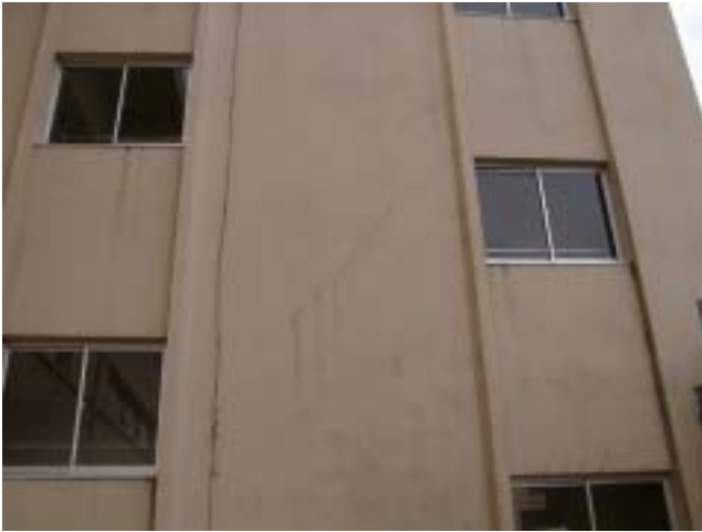
写真-48 十日町総合高校管理棟に接続する階段室の梁間方向のせん断ひび割れ。
