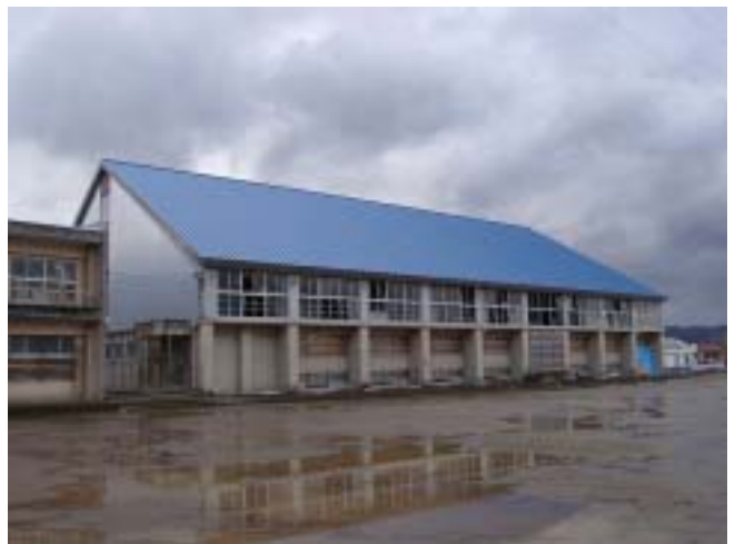
写真-32 十日町中学校体育館の外観。ほとんどの屋根ブレースが座屈あるいは破断したとのこと。既に取り替え作業が始まっていた。中破。
