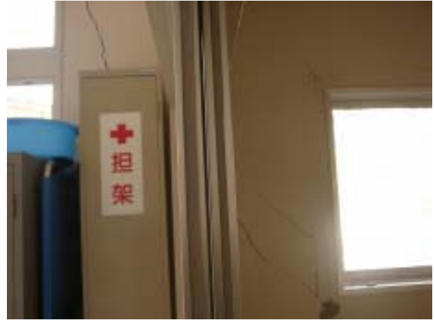
写真-51 同じ極短柱のせん断破壊を内側からみる。
