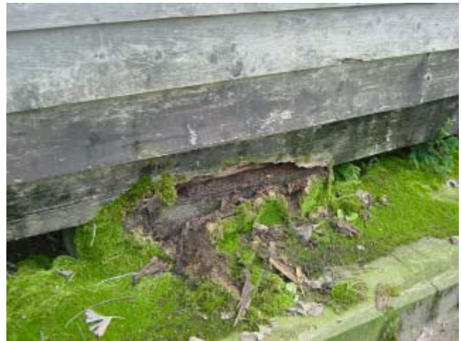
写真4. 腐朽した基礎
