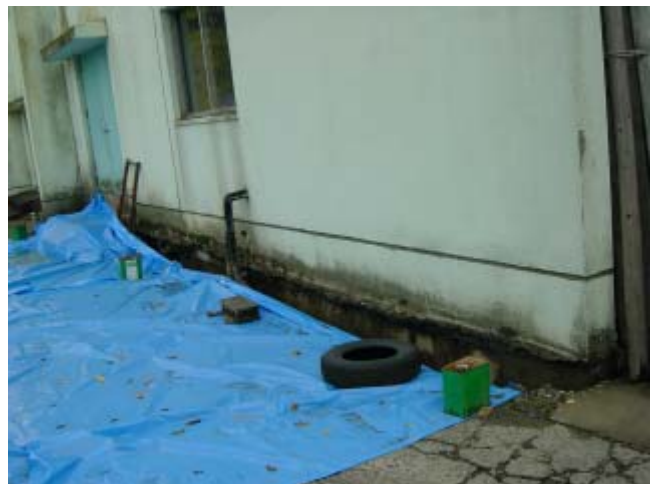
写真3．校舎北西部の地番の沈下
