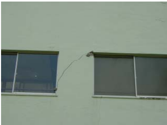
写真4 . 北側2階柱のせん断ひび割れ
