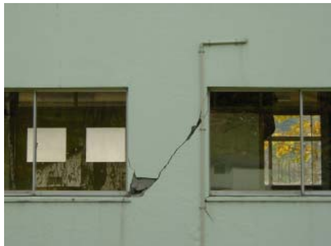
写真5 . 北側1階柱のせん断ひび割れ
