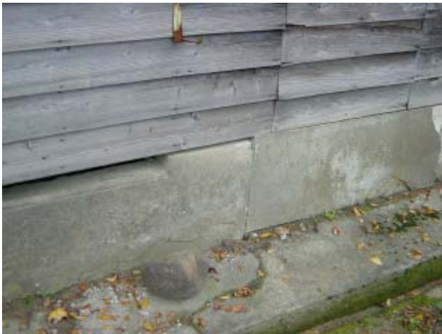
写真3. 基礎コンクリートのずれ
