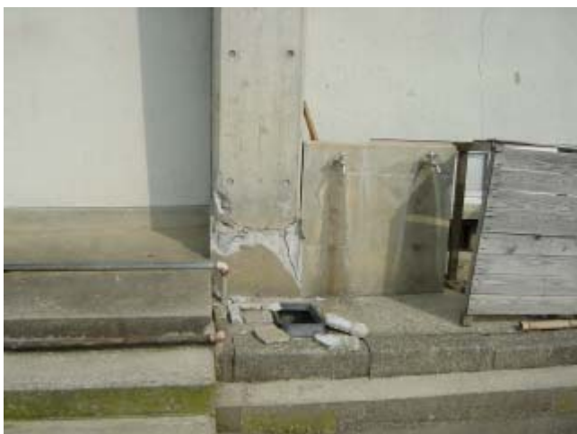
写真8 . 体育館 RC 部分の損傷（鉄筋座屈）
