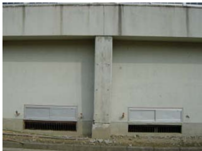
写真9 . 体育館 RC 部分の損傷
