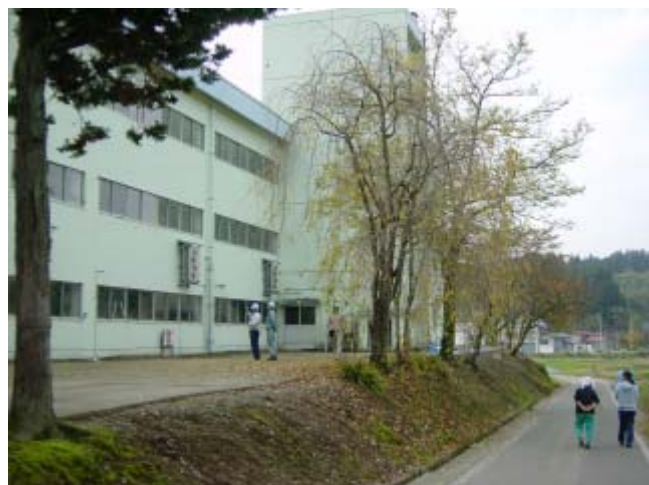
写真7 . 校舎北側（盛り土部分が沈下）
