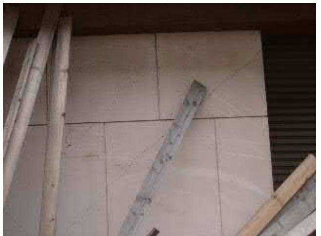
写真-7 十日町市役所の妻面の袖壁に斜めひび割れが見られた。
