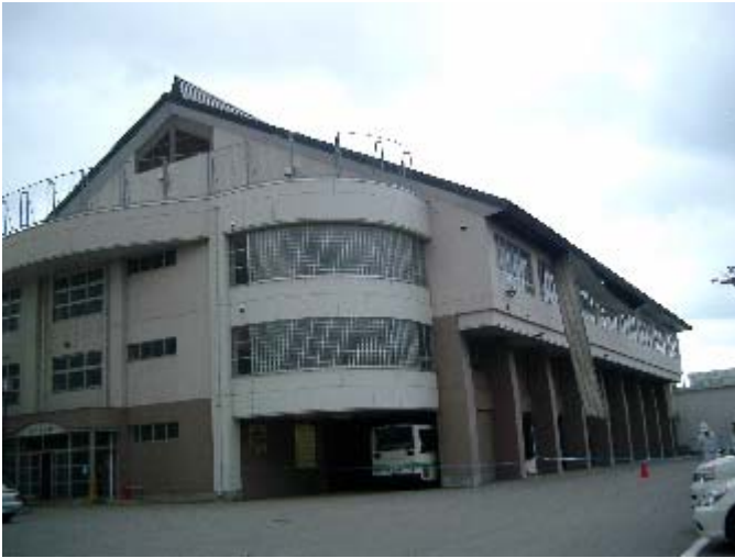
写真-51 川西中学校体育館の外観。軒裏仕上げ材，雪囲い受けに被害が見られた。詳細は次の写真。
