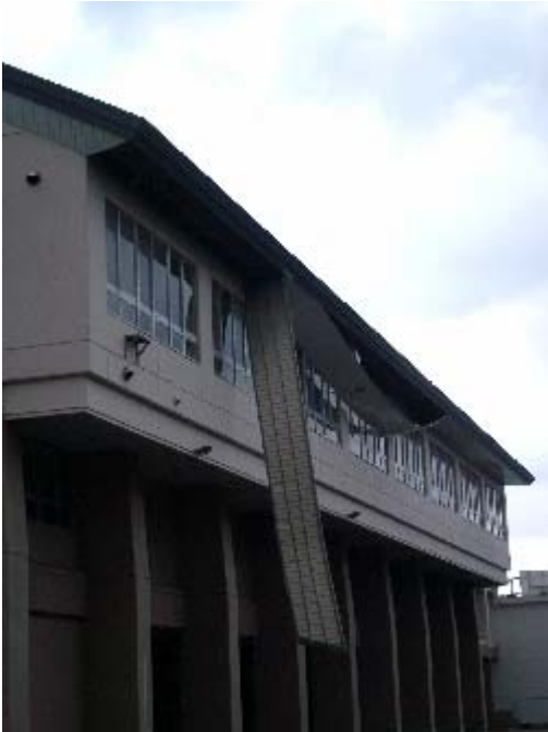
写真-52 軒裏仕上げ材が剥離し垂れ下がる。
