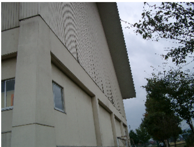
写真-13 南中学校体育館の妻部の外壁の浮き上がり。
