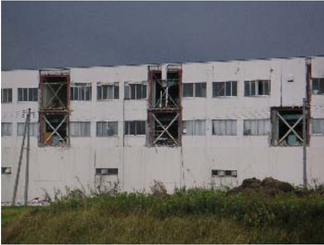
写真-55 外壁ALC版の脱落。
