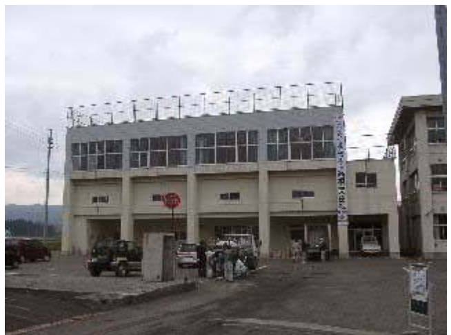
写真-10 南中学校西側の棟 (RC3F) の外観。被害は軽微。
