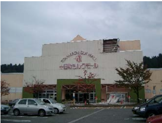
写真-16 十日町シルクモール建物の外壁の損傷状況。外壁ALC版が落下した。
