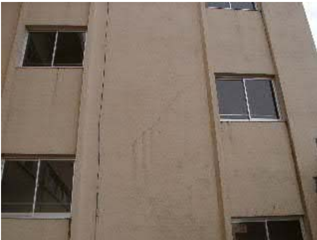
写真-28 十日町総合高校東側の棟に接続する階段室の張間方向のせん断ひび割れ。
