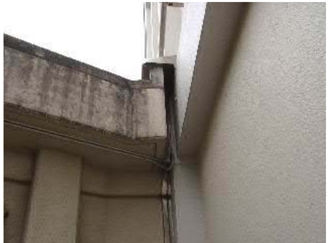
写真-20 渡り廊下棟と南側棟の EXP.J.に若干の損傷が見られた。
