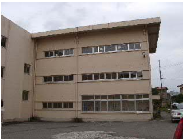
写真-29 十日町総合高校東側の棟の西面南側の外観。1F の中央の短柱（極脆性柱）にせん断ひび割れが生じていた、詳細は次の写真。
