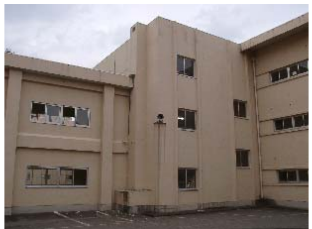
写真-32 東側棟の階段室との取り付け部の破壊。
