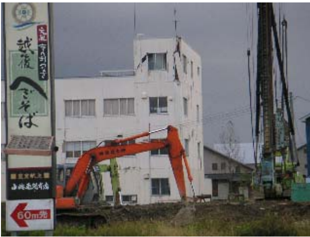
写真-56 ペントハウスの被害。外壁のALC版のせん断破壊がみられる。
