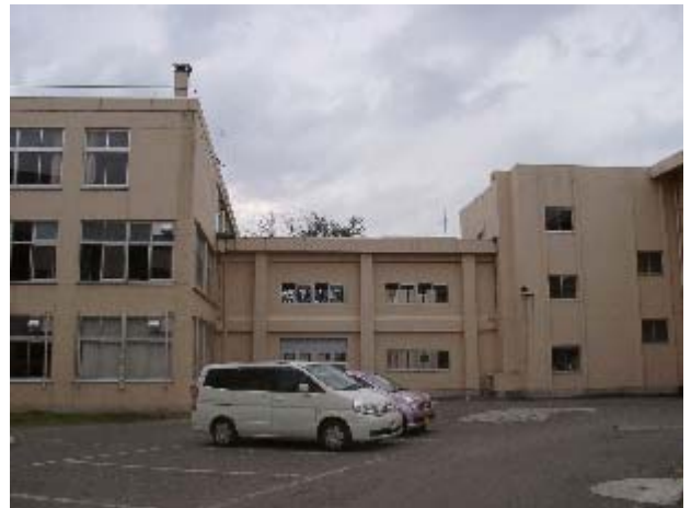
写真-31 十日町総合高校東側の棟と中央の棟を繋ぐ渡り廊下棟（RC2F）。両側の接続する部分にコンクリートの剥落がみえる。詳細は以下の 2 枚の写真。
