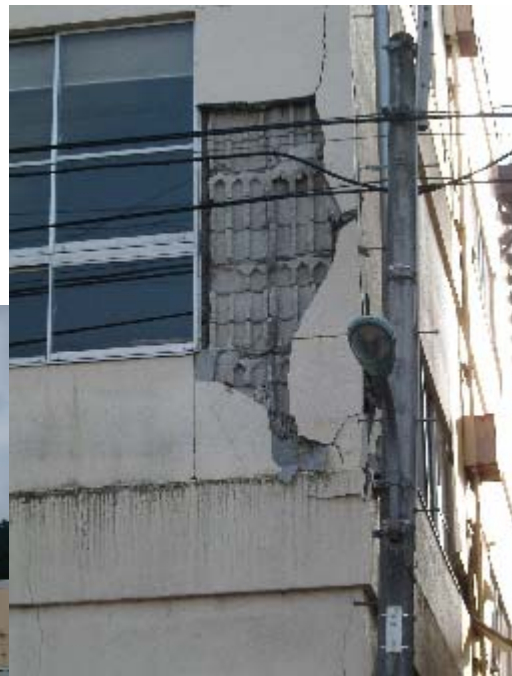
写真-39 ブロック造外壁の損傷状況。鉄骨躯体に約10cm厚のブロックが使われている。
