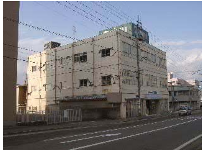
写真-24 鉄骨造店舗ビルの外観。外壁はブロックであり、大きく損傷を受けていた。一部は落下している。詳細は次の写真。
