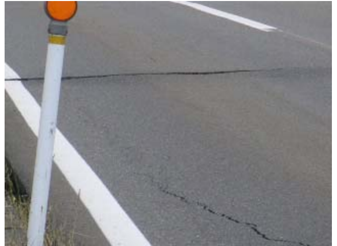
写真-57 鉄骨建物付近の道路に亀裂が見られた。
