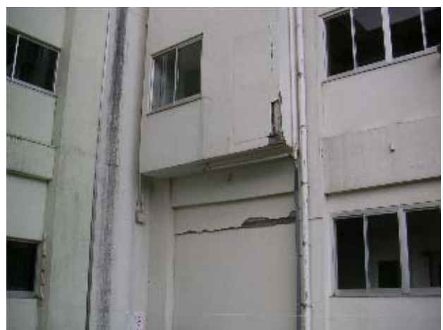
写真-50 管理棟 (左) と一般の教室棟 (右) の境にコンクリートの剥落がみられた。
