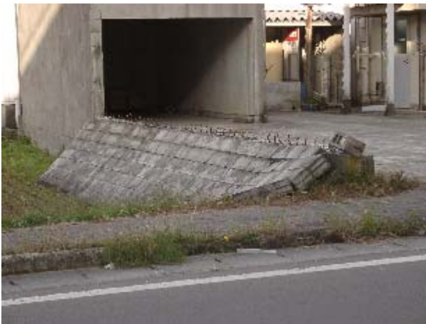
写真-46 コンクリートブロック塀の転倒
