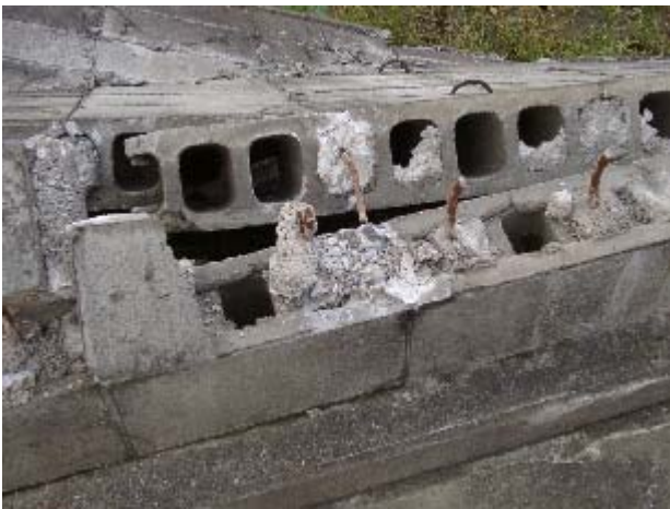
写真-47 塀の縦筋の配筋状況。定着長の不足及び縦筋の継手の不良がわかる。
