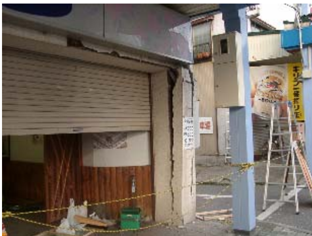
写真-43 S 造3F 建物の1F 柱の仕上げモルタルが剥離している。
