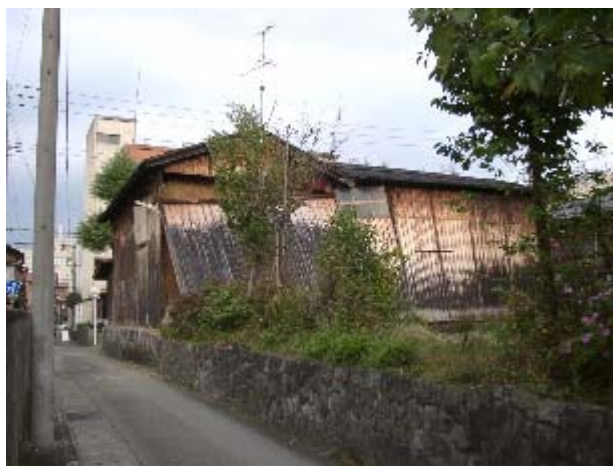
写真-45 傾斜した住宅。大破 周辺道路へは立入り禁止。
