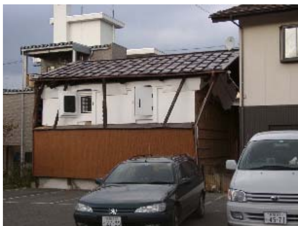
写真-44 土蔵の被害状況。土壁の剥がれおよび壁の傾き。
