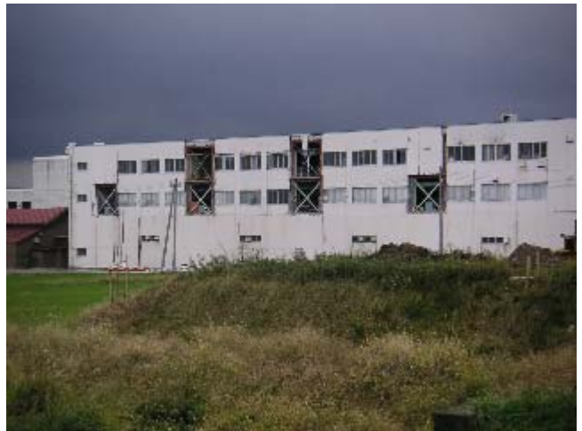
写真-54 鉄骨造建物の全景。外壁ALC版，ペントハウスに被害が見られた。詳細は次の2枚の写真。
