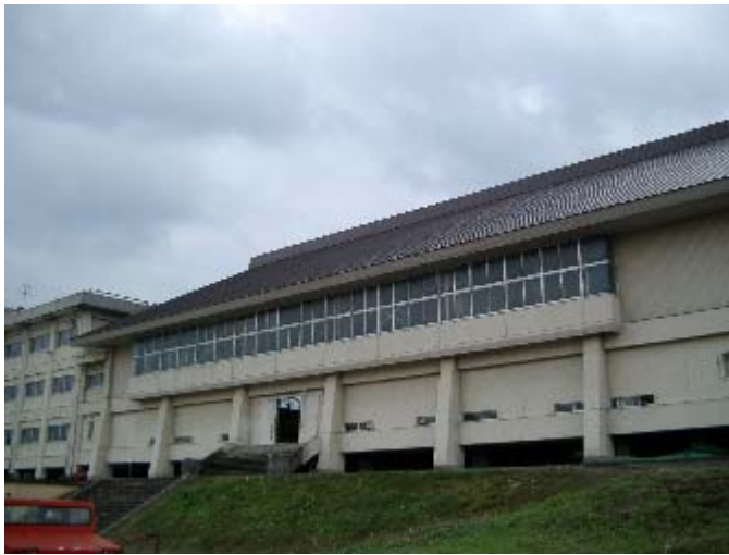
写真-12 南中学校体育館の外観。その向こうに見えるのは東側中央の棟の外観。両建物とも1Fに階高の低いピロティ形式になっている。体育館は妻部外壁仕上げ材と1層RC部に軽微被害が観察された。詳細は以下の写真に示す。
