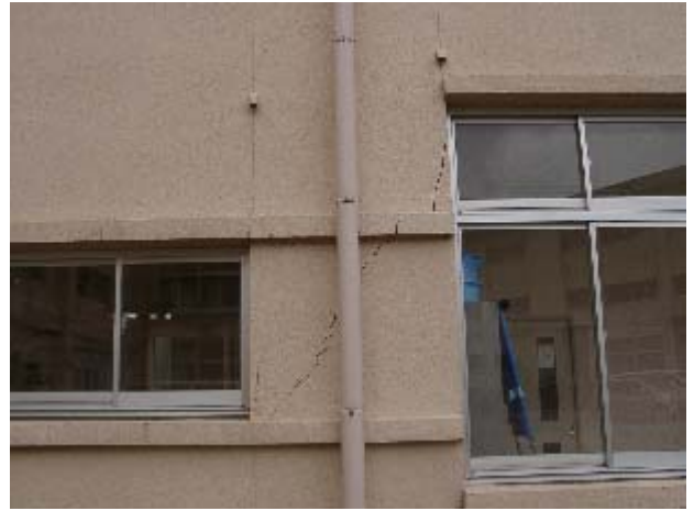
写真-30 極短柱のせん断破壊。ひび割れ幅 5mm 程度、K 型ブレースで補強されていた建物。直交壁があるため、診断では第 2 種構造要素とはならず排除されていたものと思われる。
