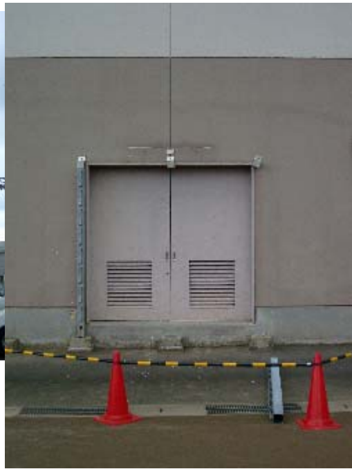
写真-53 雪囲い受け材の脱落がみられた。
