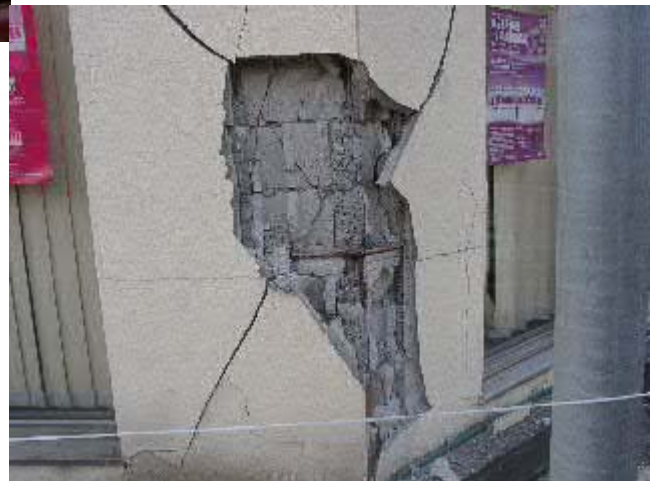
写真-40 柱脚部分のブロック造外壁の損傷状況。
