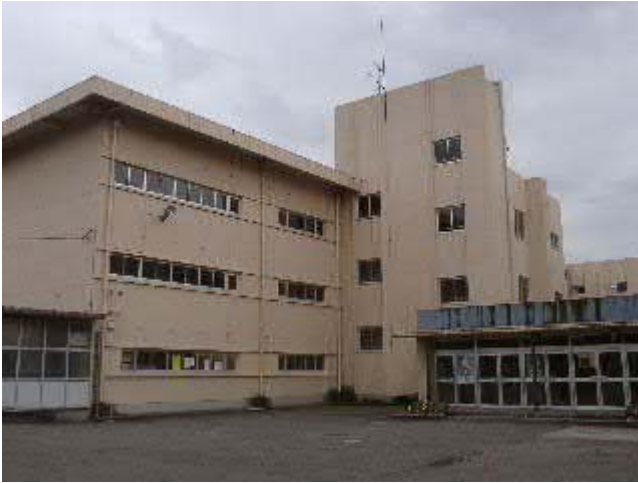
写真-27 十日町総合高校東側の棟の西面（前の写真の裏側）外観。接続する階段室に張間方向のせん断ひび割れが見える（次の写真）。
