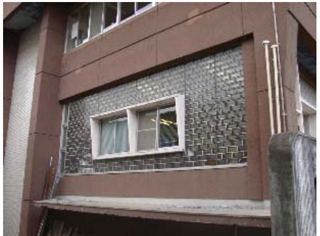
写真-6 十日町市役所の妻面のガラスブロック壁の一部が落下していた。
