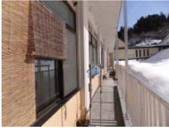
写真5 安塚やすらぎ荘南面の1階の柱 ( 損傷度 あるいは のせん断ひび割れ が観察された。)
