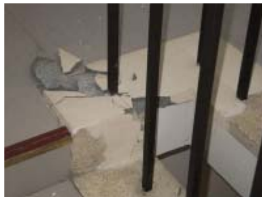
写真10 安塚やすらぎ荘北側階段の2階 スラブ位置の損傷
