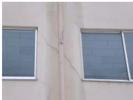
写真 51 松之山中学校 RC 造 2 階のせん断ひび割れ（3mm）柱（損傷度 s~ s、外側）
