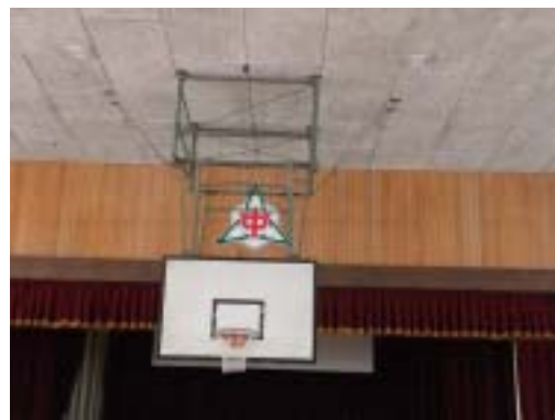
写真 55 松之山中学校体育館内部（バスケットのポールが変形）
