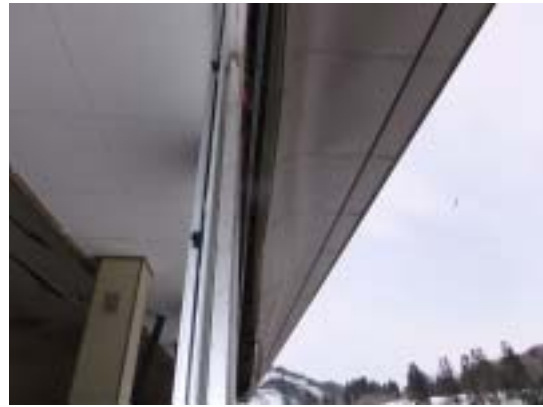
写真 26 津南町上郷中学校体育館のサッシ (取り付け部がめくれあがっている)
