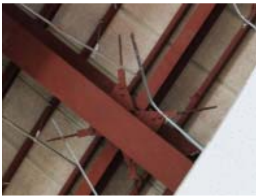
写真 33 津南町上郷小学校体育館天井 (屋根ブレースの破断)
