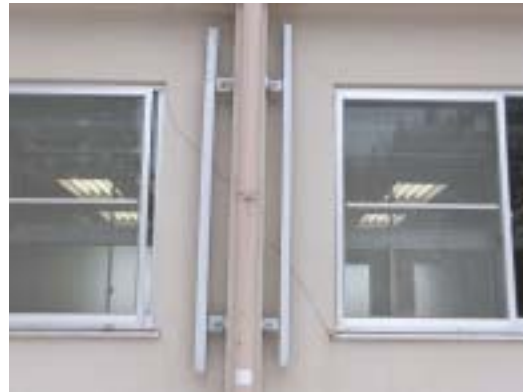
写真 53 松之山中学校 RC 造 1 階のせん断ひび割れ柱（損傷度 s、外側）
