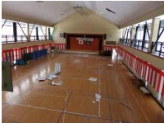
写真 25 津南町上郷中学校体育館内部 (落下した天井の一部が散乱)
