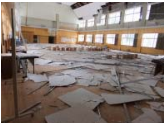
写真 35 津南町上郷小学校体育館天井 の落下(ボード類が落下)
