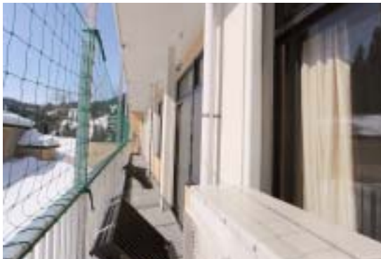
写真7 安塚やすらぎ荘南面の2階の柱 ( 損傷度 のせん断ひび割れが観察され た。)
