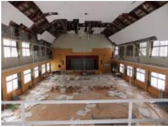
写真 31 津南町上郷小学校体育館内部 (天井が広範囲に落下している)
