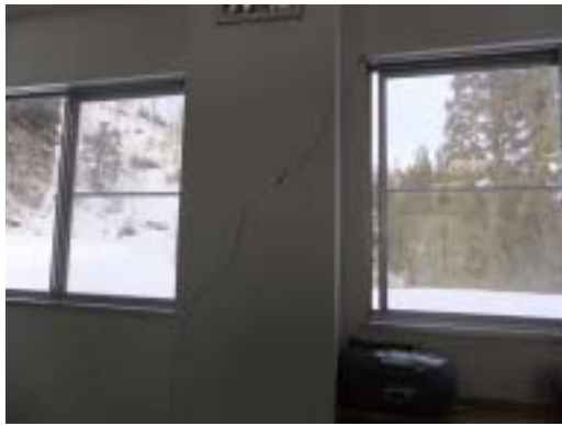
写真 52 松之山中学校 RC 造 1 階のせん断ひび割れ柱（損傷度 s、内側）
