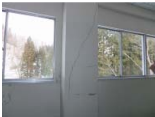
写真 50 松之山中学校 RC 造 2 階のせん断ひび割れ（3mm）柱（損傷度 s~ s、内側）
