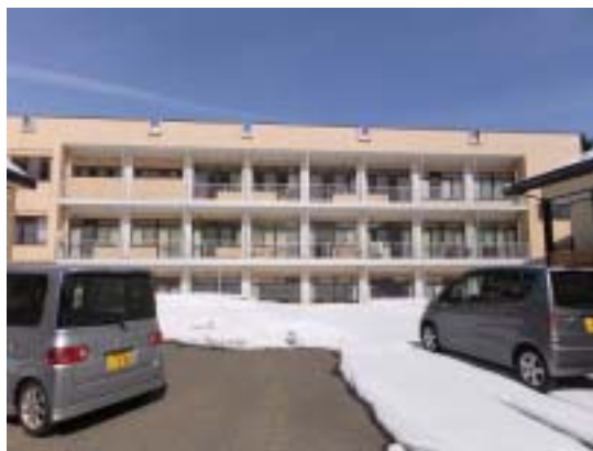
写真4 安塚やすらぎ荘南全景(手前の柱の1階2階部分に損傷度あるいはのせん断ひび割れが観察された。)
