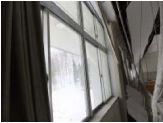
写真 37 津南町上郷小学校体育館のサッシ（サッシには大きな損傷は見られない）
