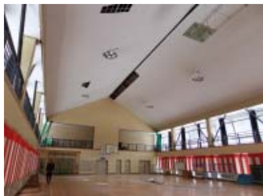
写真 23 津南町上郷中学校体育館内部 (天井の一部が落下)
