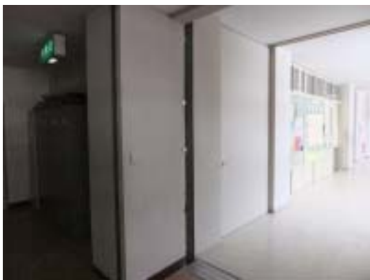
写真 27 津南町上郷中学校体育館から RC 造校舎をみる (EXP.J. に若干の損傷が みられる)
