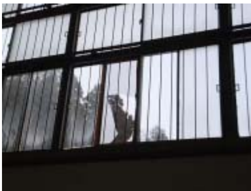
写真 56 松之山中学校体育館内部（ガラスの破損）
