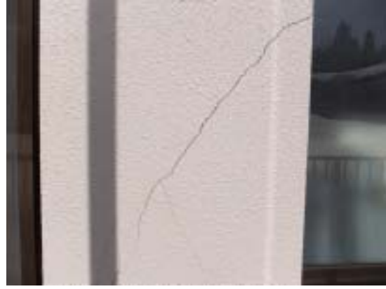
写真6 安塚やすらぎ荘南面の1階の柱( 損 傷度 のせん断ひび割れ( ひび割れ幅は仕上 げ上で2mm ))
