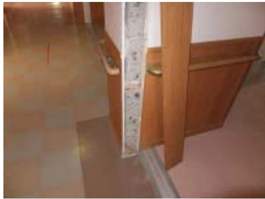
写真 12 安塚やすらぎ荘北側2階の鉄骨部分へのEXP.Jの損傷
