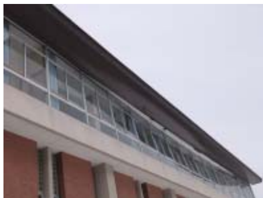
写真 21 津南町上郷中学校体育館南東 面(サッシがはずれかけている)
