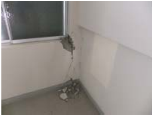
写真 11 安塚やすらぎ荘北側階段の2階の損傷
