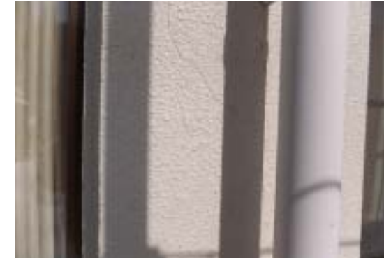
写真8 安塚やすらぎ荘南面の2階の柱( 損 傷度 のせん断ひび割れ )
