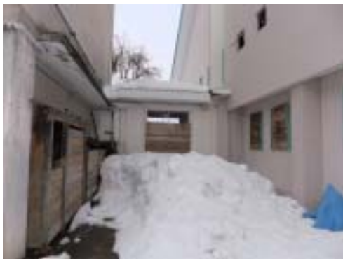
写真 59 松里小学校 RC 造校舎と体育館の渡り廊下（コンクリートに若干の損傷が見られる）
