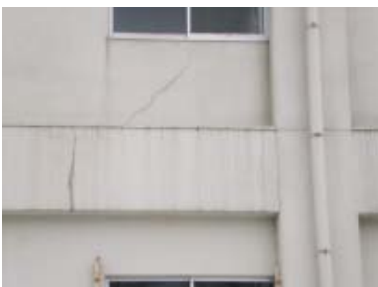
写真8 十日町市水沢中学校 RC 造 3 階校舎の腰壁のせん断ひび割れ
