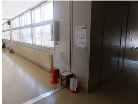
写真 20 津南小学校の 3 階建て RC 造校舎と体育館の EXP. J. (損傷は見られない)
