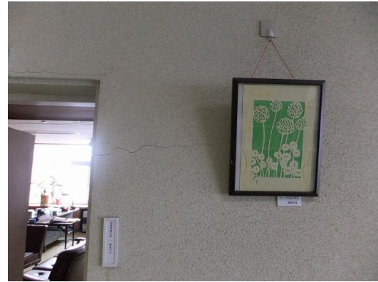
写真 47 東部小学校の RC 造部分（雑壁にはひび割れが散見された。この他階段など）
