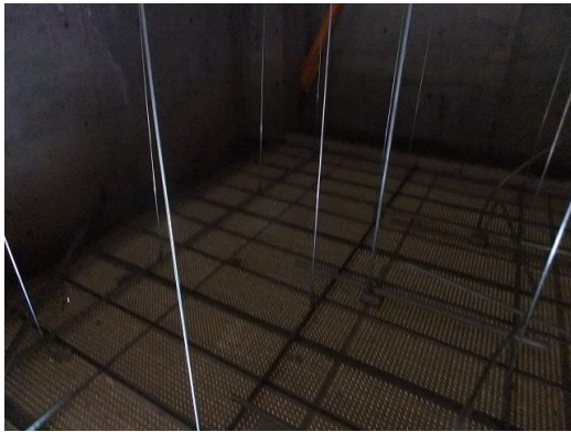
写真 9 体育館のギャラリー部の長ボルト（ボルトは2本継いであった、途中でフレアー溶接（計 2.7m）、揺れ止めはなし）
