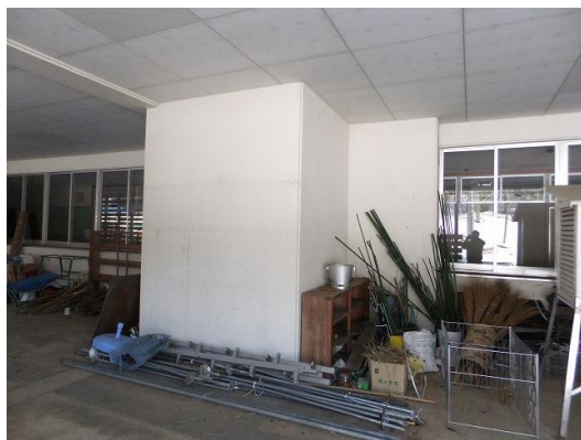
写真 34 北信小学校 RC 造教室棟の廊下と外部の境界の雑壁（多くのせん断ひび割れが観察されている）（ここから内部の柱が見えるが、仕上げにより被害は観察できない。長柱で損傷はないと思われる。）
