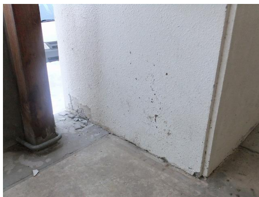
写真 32 北信小学校 RC 造教室棟の 1 階の廊下側の外の柱（前の写真の柱脚の拡大、曲げ圧壊の兆候で損傷度 II 程度か。）
