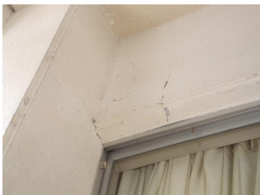
写真 29 北信小学校 RC 造教室棟の 1 階の教室側の一般柱にとりつく梁の曲げひび割れ（前の写真の拡大、曲げの損傷度 II 程度）
