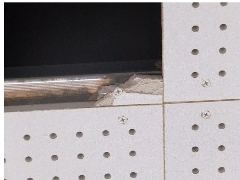
写真 12 ボードがはずれた箇所（ビスは残っており、ボード部で破壊している）
