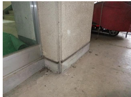
写真 49 東部小学校の体育館の下部の RC 造の柱脚部分（曲げによるひび割れ、圧壊の兆候が見られていた。）
