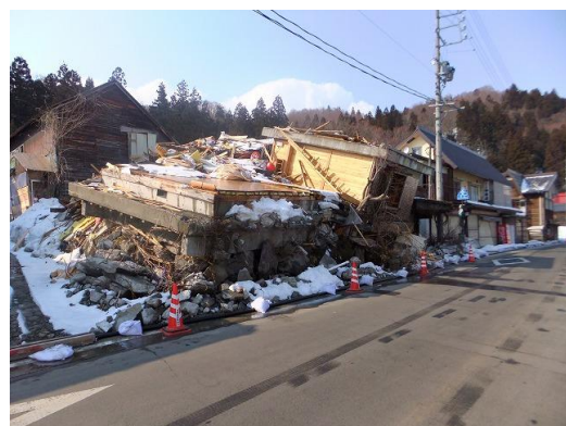
写真 39 北信小学校の近くの住宅の崩壊（手前の RC 造の土台に向こう側にみえる住宅が乗っていて、土台の崩壊により向こう側に崩落している）
