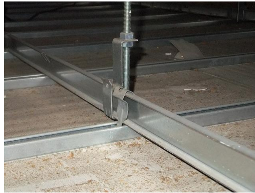
写真 10 体育館のギャラリー部の長ボルトとボードを支えるアルミ枠との接合（フックでひっかけてある）
