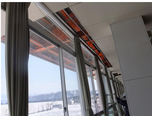
写真 15 体育館の軒天井の落下部を内部から見る(サッシが梁間方向への面外の振動で上部が損傷しているのわかる)
