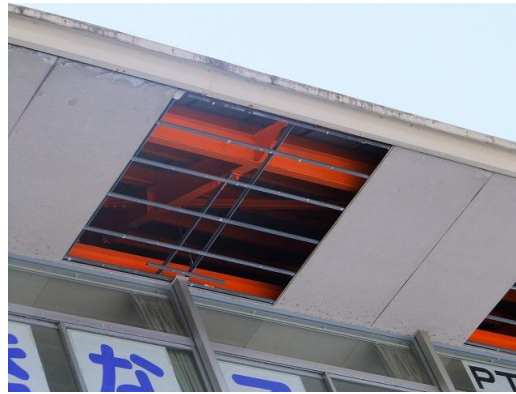
写真 14 体育館の軒天井の落下部の詳細
