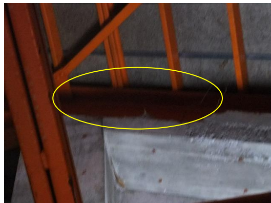
写真 18 体育館の妻面のコンクリートの剥離落下した部分の詳細(黄色い○)
