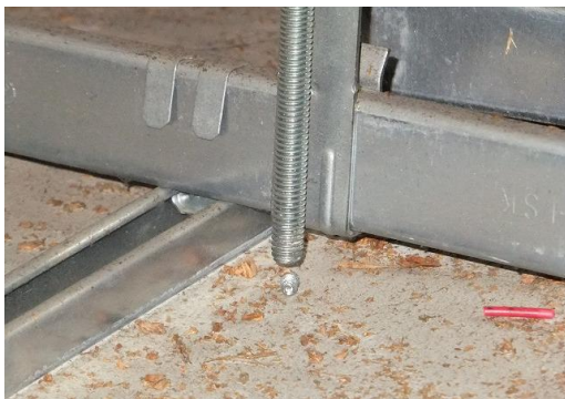
写真 11 長ボルトの先端（上下の振動で下の天井ボードに刺さる場合がある）
