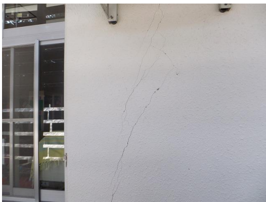
写真 27 北信小学校 RC 造教室棟の教室側のふかし柱（前の写真の柱の拡大、損傷度 II 程度のせん断ひび割れ）
