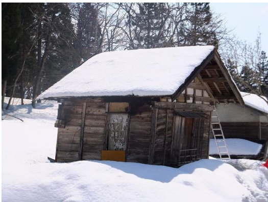
写真 21 津南小学校側から信濃川を越えて県道 49 沿いを栄村方向に向かった通行止め付近の傾いた物置
