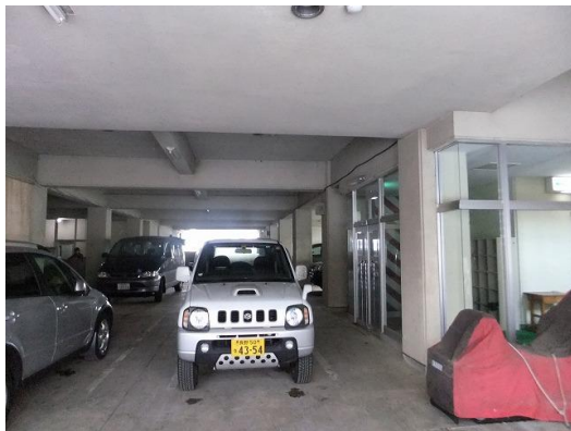
写真 48 東部小学校の体育館の下部の RC 造部分（主に駐車場などとして使っている。柱の柱脚に次の写真のような曲げによるひび割れ、圧壊の兆候が見られていた。）
