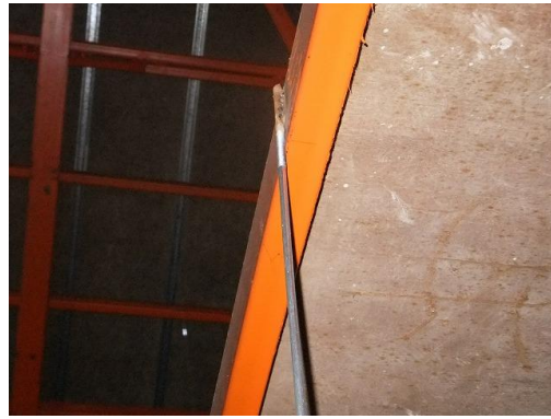
写真 8 体育館のギャラリー部の天井内部（軽量C型鋼に長ボルトが溶接されている）
