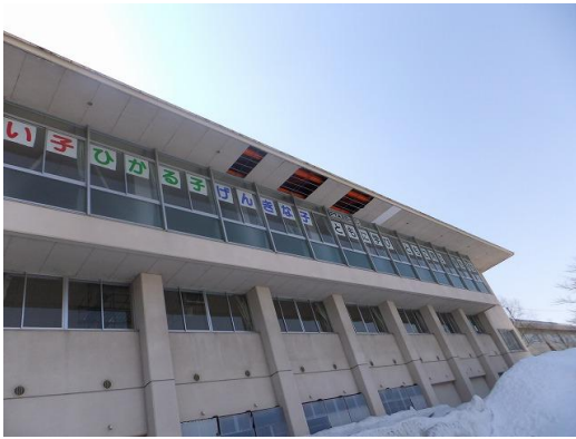
写真 13 体育館の軒天井の落下(サッシの面外へのはずれに起因していると想像される)
