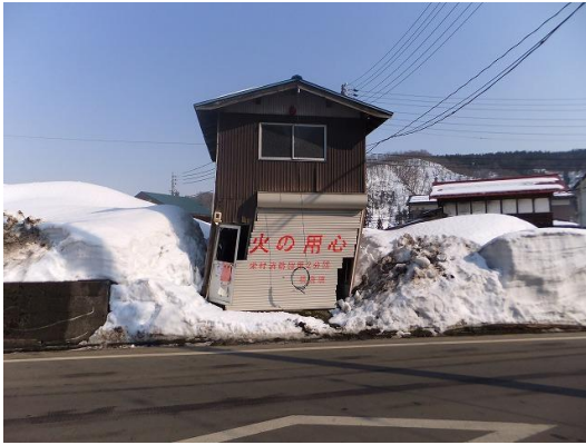
写真 40 北信小学校の近くの小屋が傾いている
