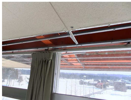
写真 16 体育館の軒天井の落下部を内部から見る(写真では見にくいですが、サッシの上の溶接部が破断していた)
