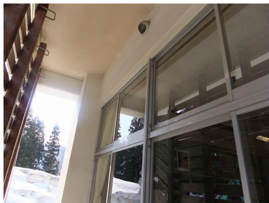
写真 28 北信小学校 RC 造教室棟の 1 階の教室側の一般柱（せいが 96cm であった（仕上げは吹付、 h_o=230\text{cm} ）。この柱には損傷が観察されていないが、とりつく梁に曲げひび割れが観察されている。）
