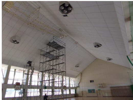
写真 2 津南小学校の体育館の内部（2か所の天井ボードが落下、足場が2つあるが、向こうの足場のボードは調査用にはずしたもの）
