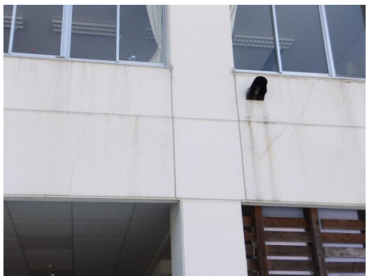
写真 33 北信小学校 RC 造教室棟の 1 階の廊下側の外の柱にとりつく梁に曲げひび割れとせん断ひび割れが観察されている。
