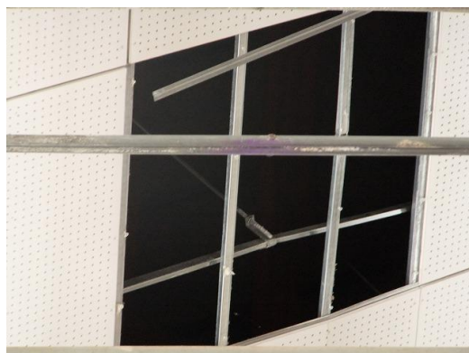
写真 4 体育館の中央付近の天井ボードの落下部の詳細（石膏ボードのビスは残っている、ボードを止めているアルミ枠が外れている）
