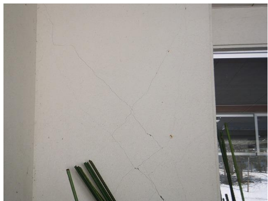
写真 35 北信小学校 RC 造教室棟の廊下と外部の境界の雑壁（前の写真の拡大、多くのせん断ひび割れが観察されている）
