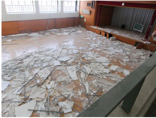
写真 46 東部小学校の天井材の落下（ボードだけでなく、アルミ支持材やつりボルト、照明器具も落下している）
