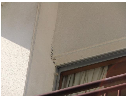
写真 30 北信小学校 RC 造教室棟の 2 階の教室側の一般柱にとりつく梁の曲げひび割れ（前の写真の直上階、曲げの損傷度 II 程度。なお、3 階は外からは観察できなかった。）
