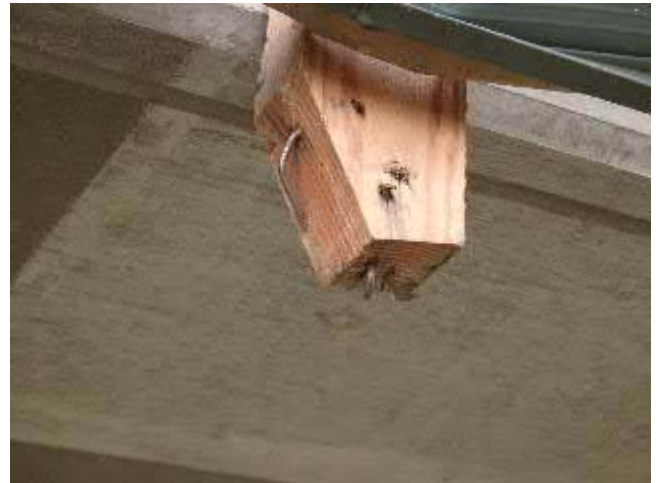
写真-10 B宅の1階の筋交い。A宅同様に、金物として貧弱である。
