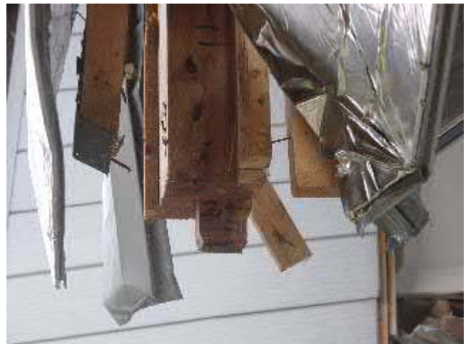
写真-5 A宅の1階の柱にほぞ(下端の突起部)がみえる。金物がみあたらないので、これのみにより土台と接合されていたと思われ、引き抜きに弱い構造になっている。
