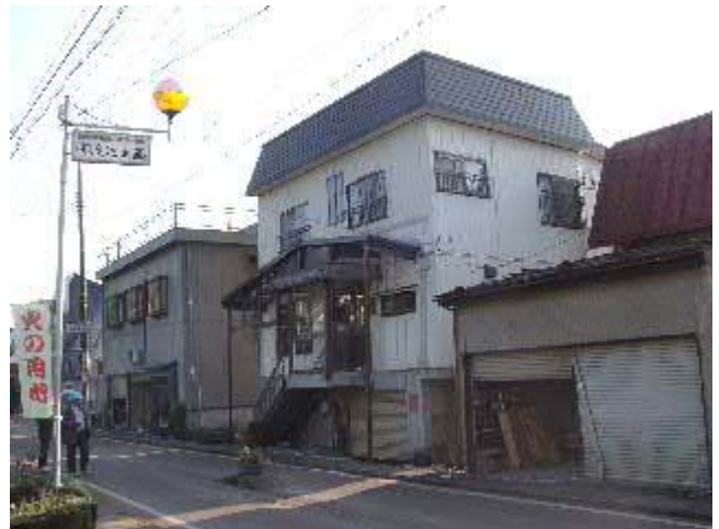
写真-48 R宅（中央）は高床式であるが、鉄骨造となっており、柱が損傷を受けている（詳細は次の写真）。
