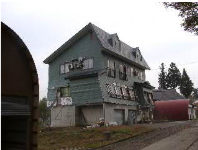
写真-8 B宅の外観。鉄筋コンクリート造の高床式住宅であるが、上部の木造建物が傾いている。
