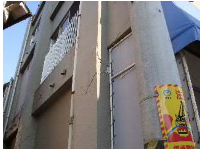
写真-41 N店舗の1階柱のせん断ひび割れ。
