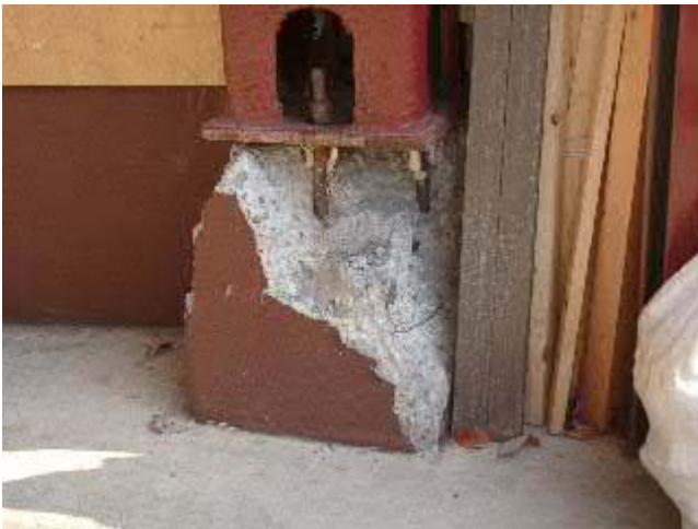
写真-45 P宅の高床式の柱脚の損傷。露出基礎のコンクリートが圧壊し、剥落している。
