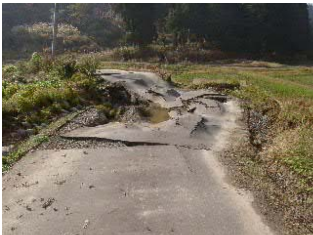
写真-33 J 宅周辺の道路の陥没。
