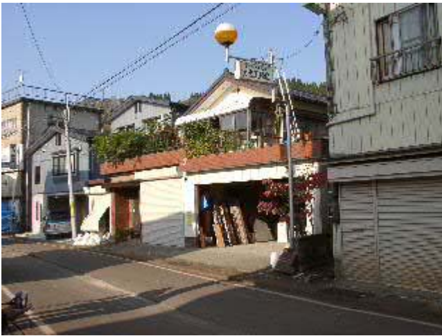
写真-44 P宅（中央）は高床式であるが、鉄骨造となっており、柱脚が損傷を受けている（詳細は次の写真）。
