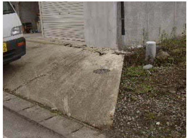
写真-16 C 宅の周辺の地盤のひび割れ。
