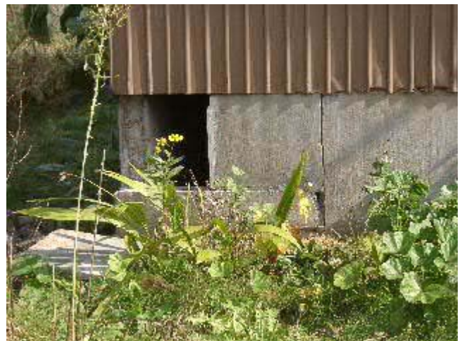
写真-32 J 宅の基礎。布基礎であるが、無筋コンクリートと思われる。この種類の基礎も古い建物に多い。ブロックのようにばらばらになってしまう
