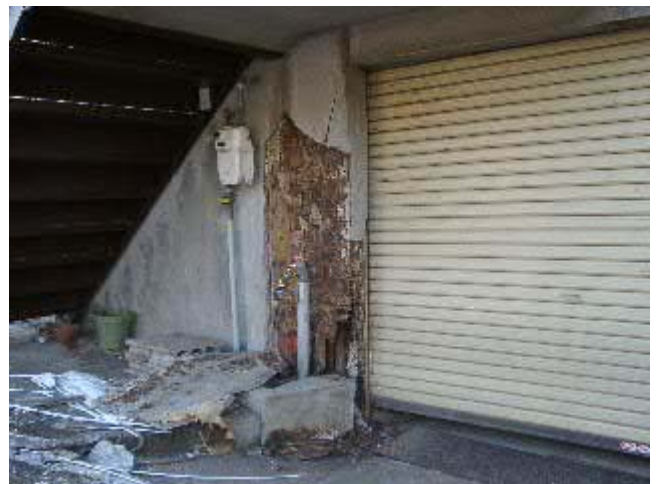
写真-49 R宅の鉄骨造の柱。鉄骨柱の外装材が落下している。大きく変形したことを物がたっている。
