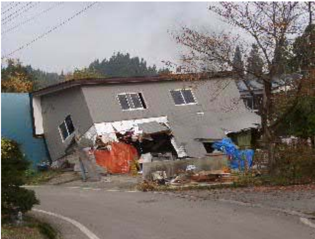
写真-18 D 作業場の外観。鉄筋コンクリート製布基礎建物の倒壊。
