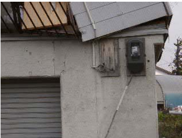
写真-3 A宅の高床式の鉄筋コンクリート部分の開口隅角部にひび割れが生じていた(次の写真に詳細)。これは鉄筋コンクリート構造としては軽微な被害であるが、それでも上部が軽い木造構造であることを考えると、大きな地震力が作用したことが伺われる。
