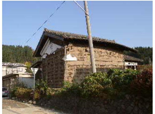
写真-59 土塗りの歴史的建物の被害。土壁が剥落し、傾いている。
