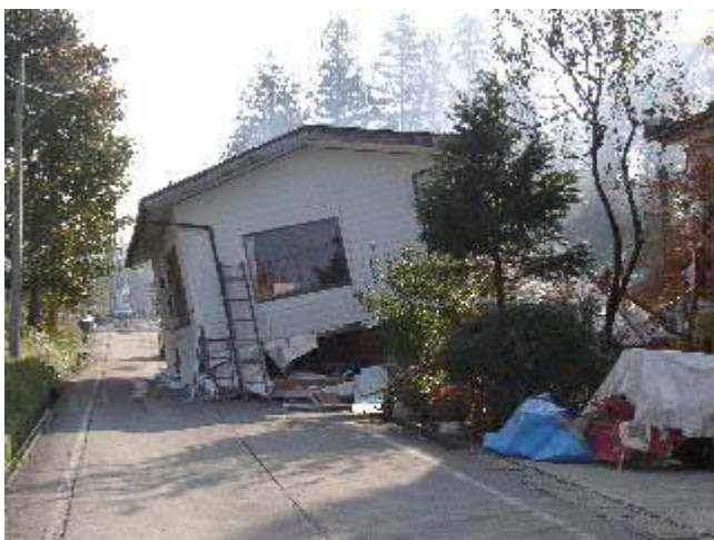
写真-34 K 宅の外観。1 階が崩壊。
