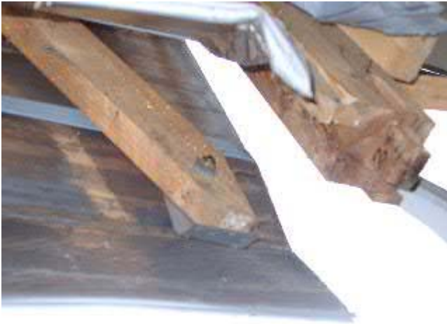
写真-7 A宅の1階の筋交い。筋交いは50mm×100mm程度であった。柱にはくぎ2本で固定され、土台には薄い鉄板1枚を介して、固定されている。金物として貧弱である。
