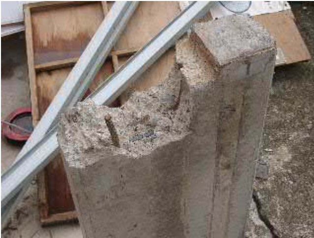
写真-28 G 作業場の別な鉄筋コンクリート製布基礎のコンクリートの剥落。鉄筋がみえるが、この鉄筋の役割は剥落部分にあったであろう上の木造建物からの定着部との力の伝達である。しかし、この配筋法ではその効果は期待できない。木造建物の基礎の鉄筋コンクリートも、一般の鉄筋コンクリート造建物のような配筋法が必要である。
