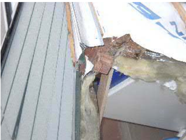
写真-9 B宅のはずれた柱の下端部分。A宅と同
