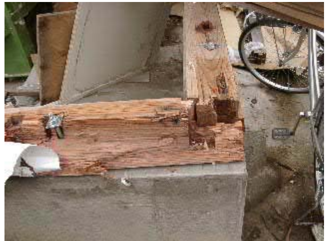
写真-20 D 作業場の土台。土台自体は基礎に緊結されていたようだが、柱が引っ張り力に耐えられず、抜けている。ほぞ穴がみえる。鉄筋コンクリート造の布基礎自体は土間コンの影響で損傷がないようだ。
