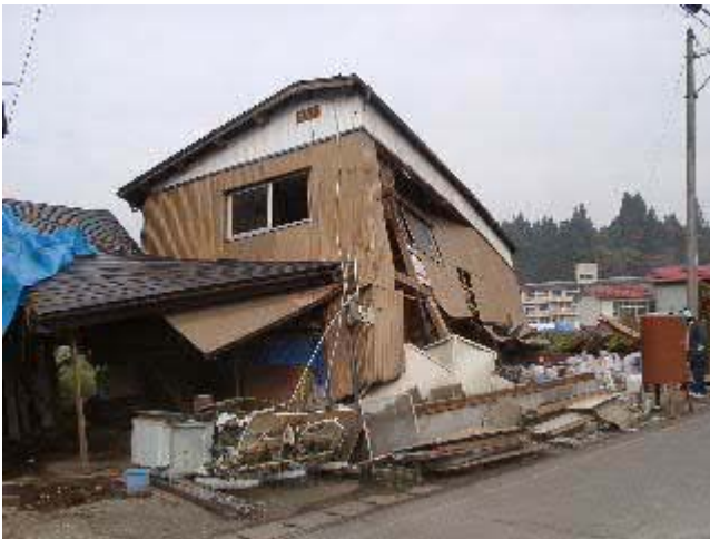
写真-29 H 宅の外観。倒壊。
