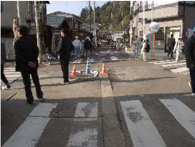
写真-39 主要地方道小千谷 - 川口 - 大和線の道路の被害 2、前の写真の反対方向。
