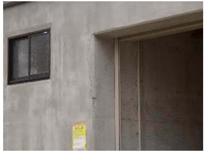
写真-15 C 宅の高床式の鉄筋コンクリート部分の開口脇にかぶりコンクリートの剥離寸前の箇所があった。これは鉄筋コンクリート構造としては軽微な被害であるが、それでも上部が軽い木造構造物であることを考えると、大きな地震力が作用したことが伺われる。
