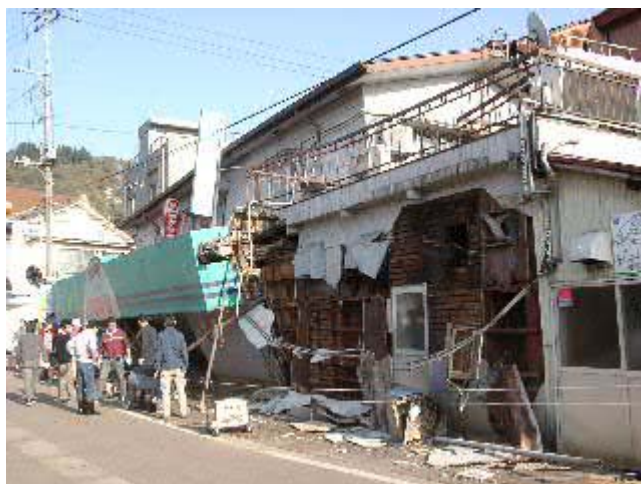
写真-37 M 店舗の外観。倒壊寸前である。
