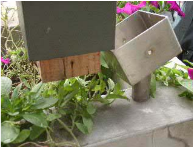
写真-13 B 宅の玄関の柱のずれ。ただしこれは化粧の柱で構造体ではない。
