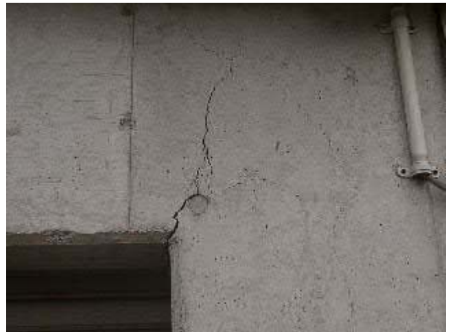
写真-4 A宅の高床式の鉄筋コンクリート部分の開口隅角部のひび割れがの詳細。
