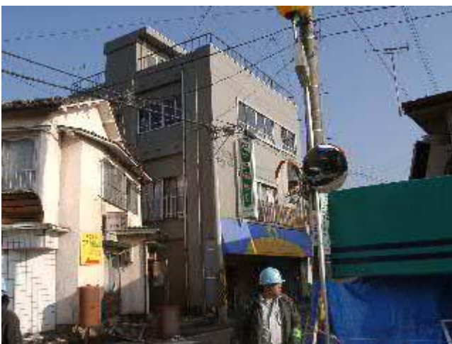
写真-40 N店舗。RC 3階。柱にせん断ひび割れが観察され、柱脚のコンクリートが剥落している。
