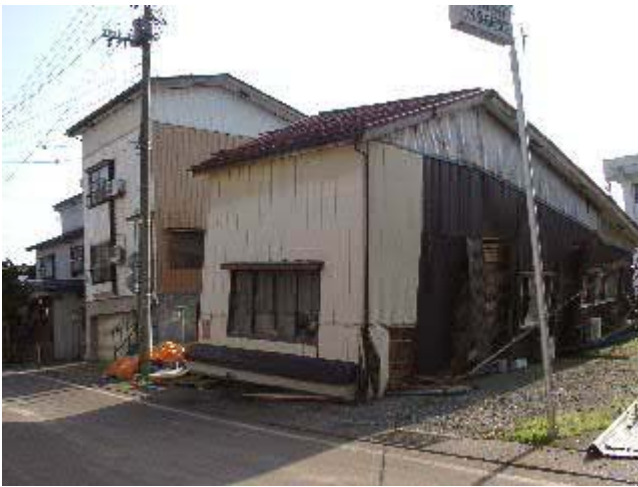
写真-56 W1宅（左、高床式住宅、被害軽微）とW2宅（右、高床式住宅ではない、倒壊）。
