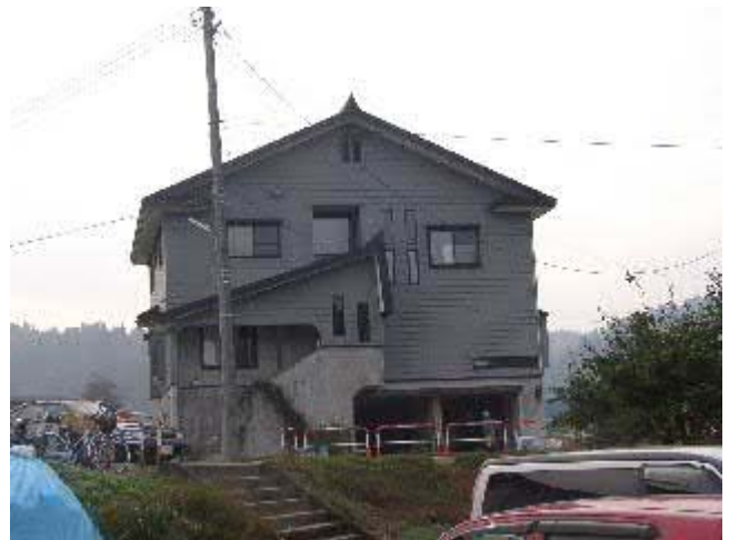
写真-30 I 宅の外観。田麦山小学校近くの鉄筋コンクリート造の高床式住宅で、軽微な被害と思われる。
