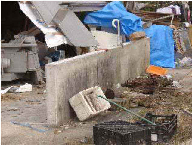
写真-19 D 作業場の鉄筋コンクリート製布基礎。布基礎は土間コンの影響で損傷は少なかった。しかし、車等の出入り口のため、正面は基礎の立ち上がり部がない。このため、基礎全体としての面内剛性が不足（剛床が成立していない）し、上部の建物に悪影響を及ぼしている。（注：剛床というのは床の剛性が十分高いという意味で、この剛床がなりたつと、上部の構造体は弱いところが強いところに助けられる効果が生まれる。剛床がなりたたないと、建物の一番弱いところがまず損傷し、その後、連鎖的に次々と構造体が損傷を受けることになる。）
