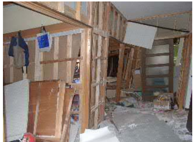
写真-11 B宅の1階内部。あるべきところ（左手前に見える壁部分）に筋交いが無い。柱と基礎との固定度の不足に加え、壁量も不足していたかもしれない。
