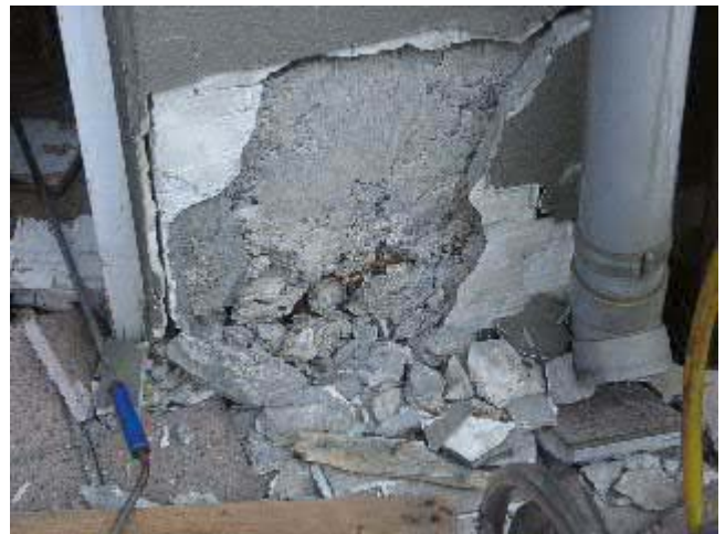
写真-42 N店舗の1階柱脚のコンクリートが剥落している。帯筋がみえるが、コンクリートの打設状態がよくない。
