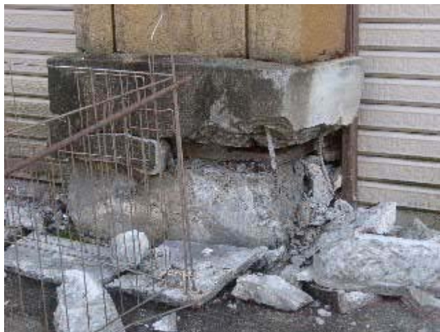
写真-36 L 宅の高床式の鉄骨の柱脚。露出基礎であり、押さえのコンクリートが剥落している。
