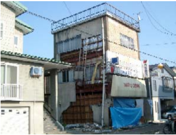
写真-55 V宅の外観。3階建てS造店舗兼住宅であるが、外壁モルタルが落下した。
