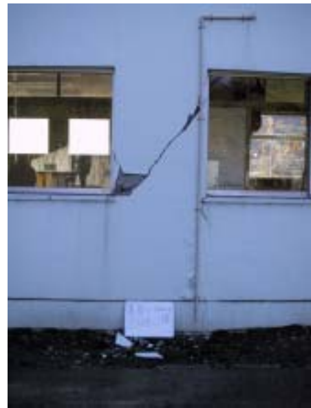
写真4 1階北側柱の損傷度 のせん断破壊
