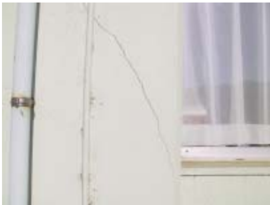
写真9 1階の南構面の損傷度のせん断ひび割れが生じた柱
