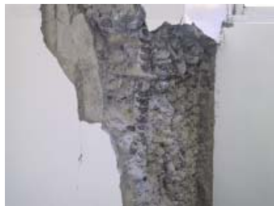
写真6 写真5の柱のコンクリートの圧壊部をみると施工不良のジャンカがみられた
