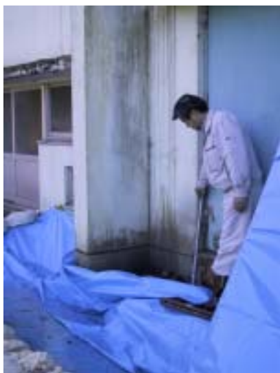
写真11 地盤が沈下した部分。約30cm。
