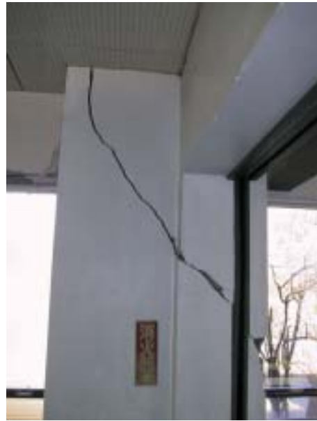
写真8 2階の北構面の損傷度の柱
