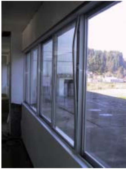
写真7 写真5の柱の横のサッシ。軸方向に縮んでいるのがわかる。
